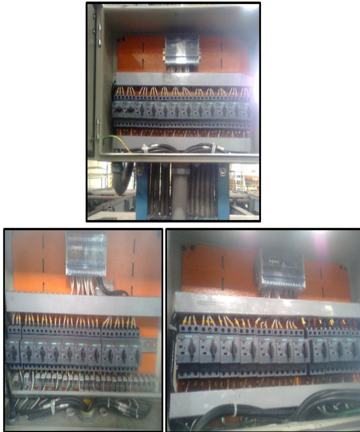
Gráfico N° 4.23: Cajas eléctricas de distribución de guardamotores
