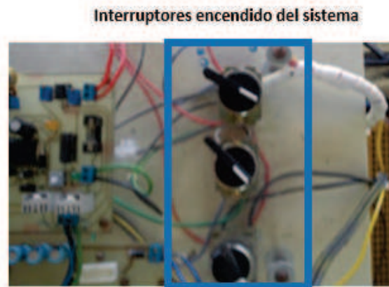
Figura 4.4: Interruptores encendido del sistema.
