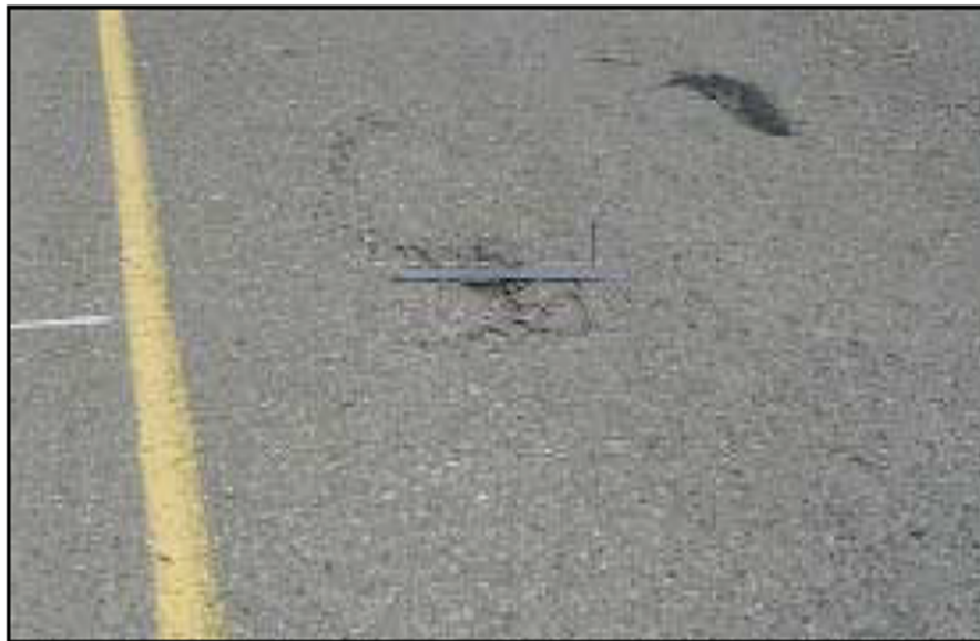
Foto 17: Bache de baja gravedad, ACP 8B.
