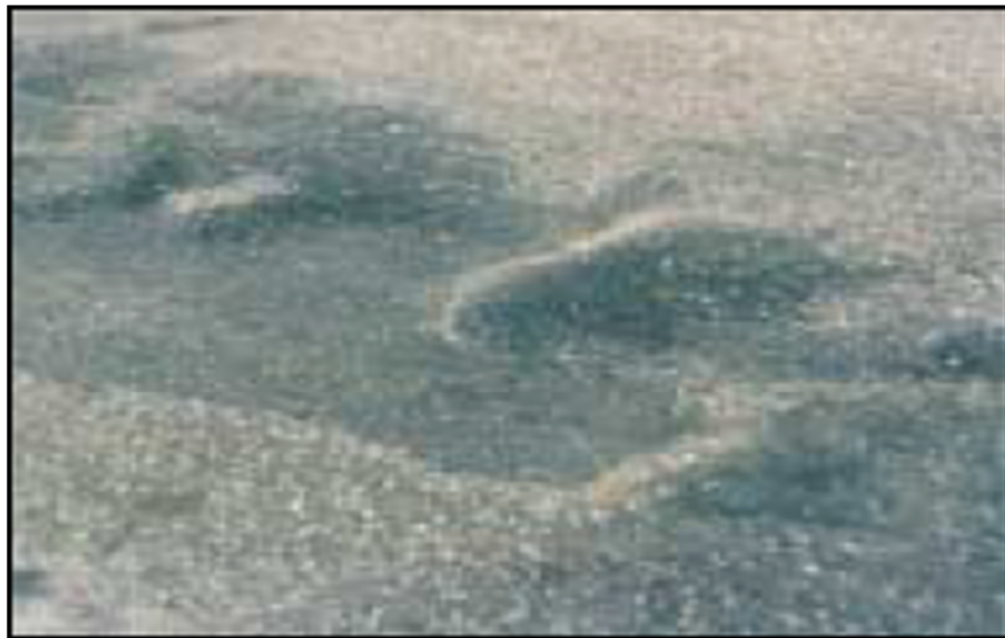
Foto 20: Falla por Corrugaciones, ACP 10.
