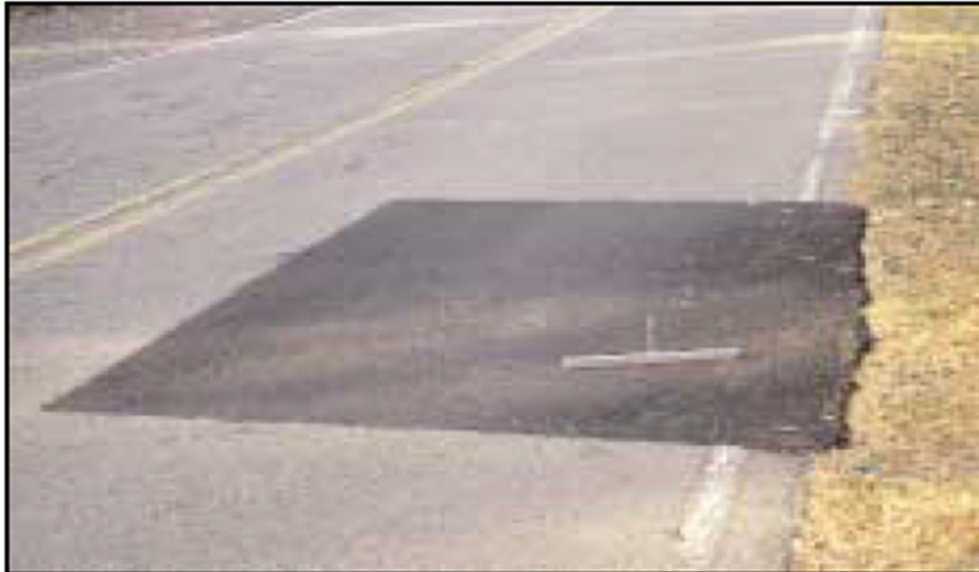
Foto 15: Deterioro de parche de moderada gravedad, ACP 7M.
