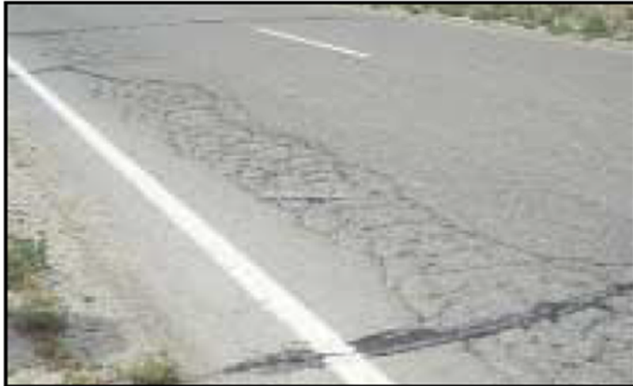
Foto 6: Falla por fatiga de alta gravedad, ACP 1A.
