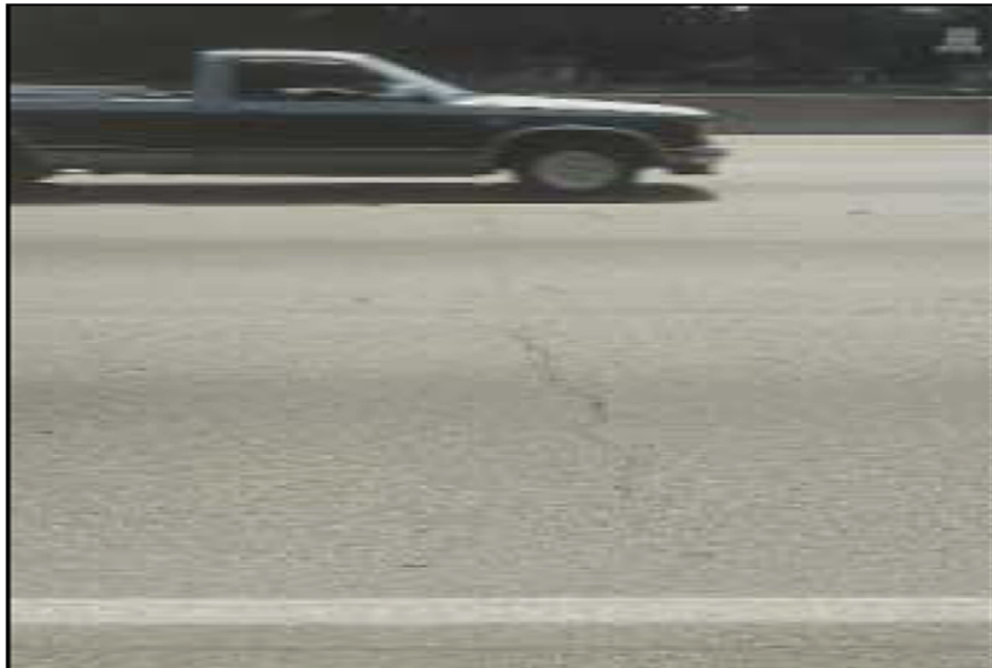
Foto 11: Falla transversal de baja gravedad, ACP 6B.
