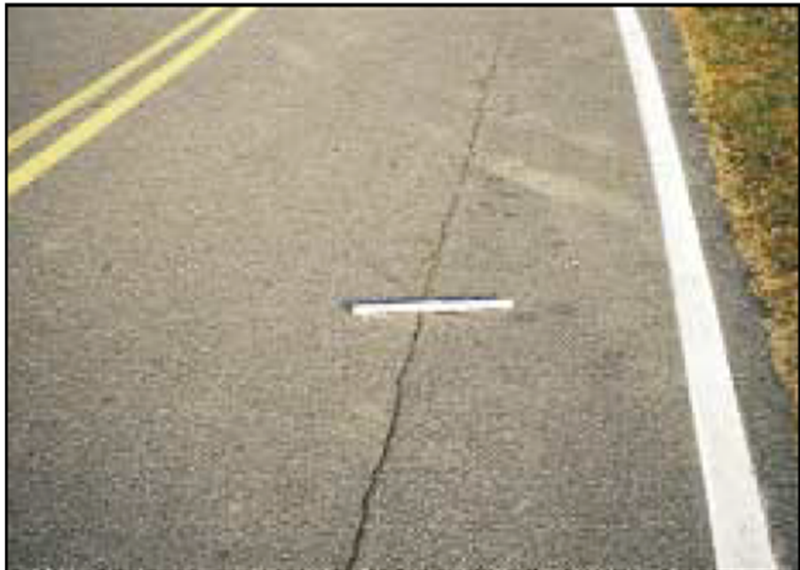
Foto 9: Falla longitudinal, en ruta de rueda, ACP 4a M.
