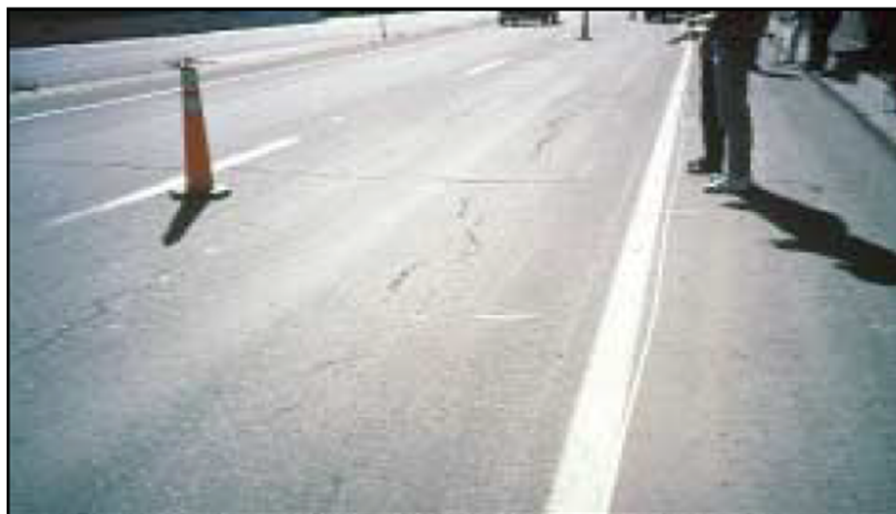
Foto 4: Falla por fatiga de baja gravedad, ACP 1B.
