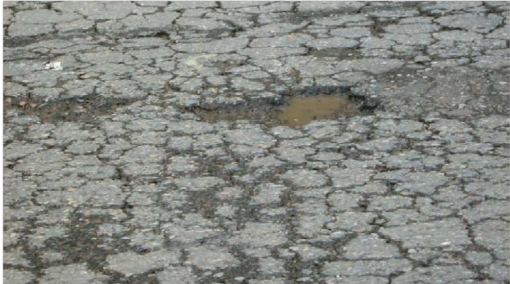
Foto 1: Pavimento deteriorado por presencia de agua.
