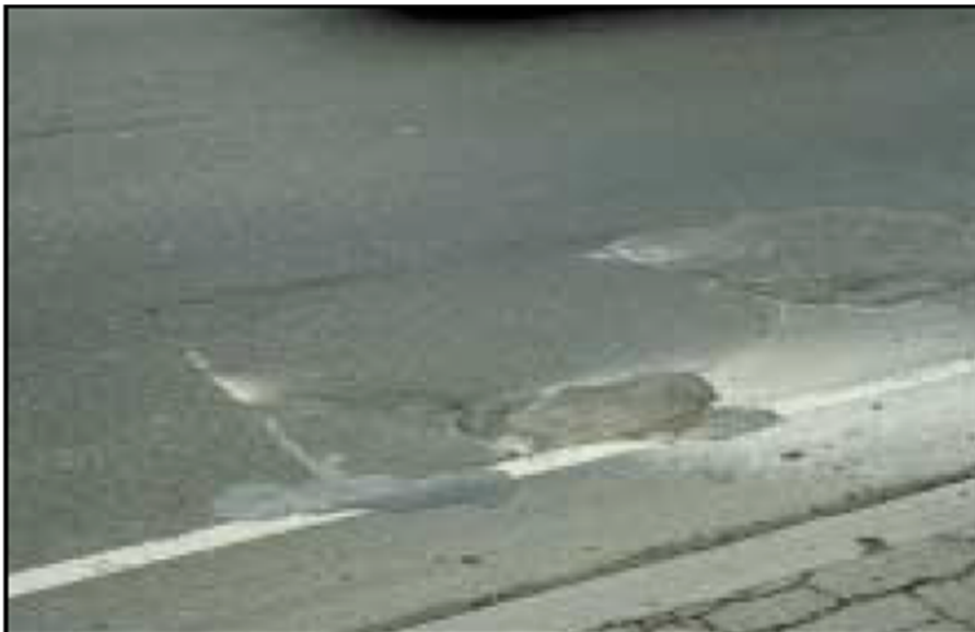
Foto 16: Deterioro de parche de alta gravedad, ACP 7A.
