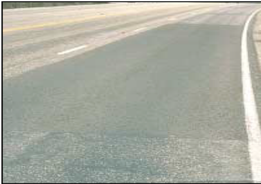
Foto 14: Deterioro de parche de baja gravedad, ACP 7B.
