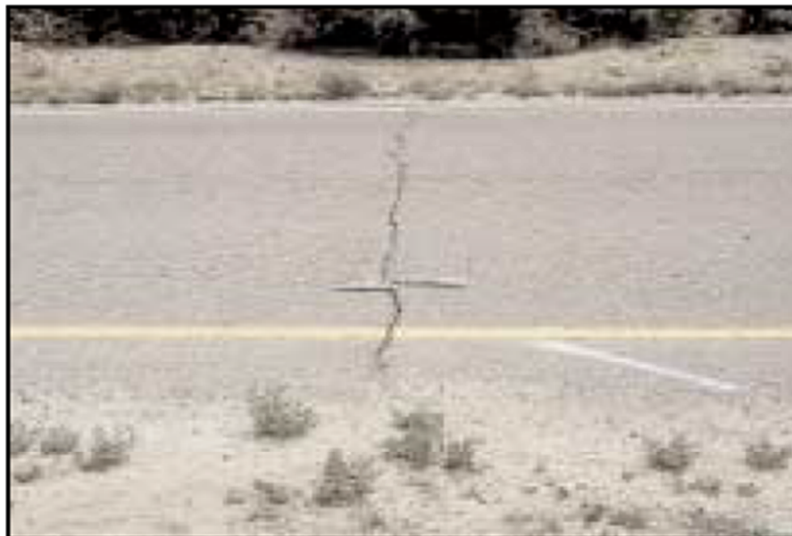
Foto 13: Falla transversal de alta gravedad, ACP 6A.
