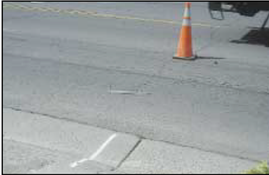
Foto 12: Transversal, moderada gravedad, ACP 6M.
