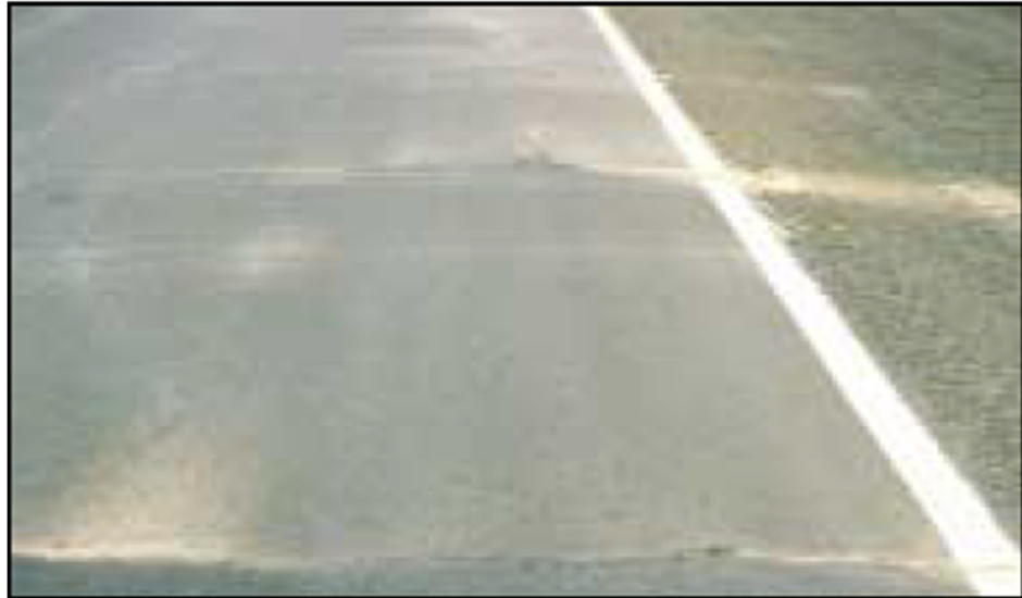
Foto 25: Material fino que queda en la superficie por expulsión de agua y bombeo, ACP 15.
