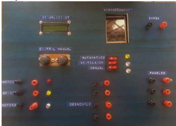
Figura 19: Sistema Adquisidor y control del Seguidor Fotovoltaico
