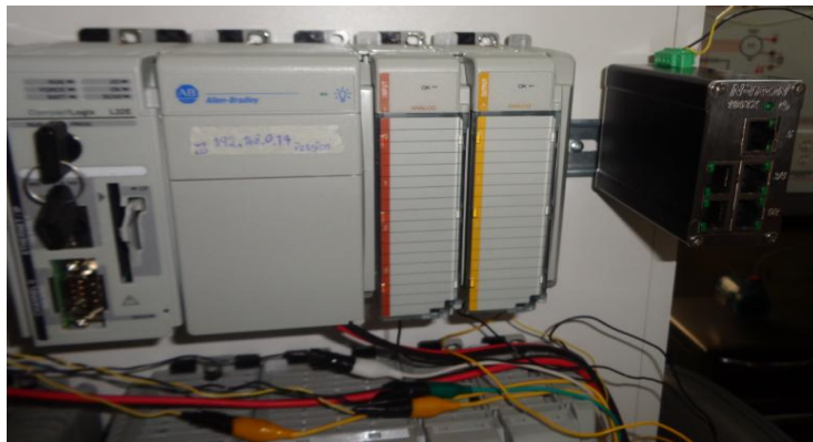
Figura 2.37: Montaje del switch para la red Ethernet Industrial.
