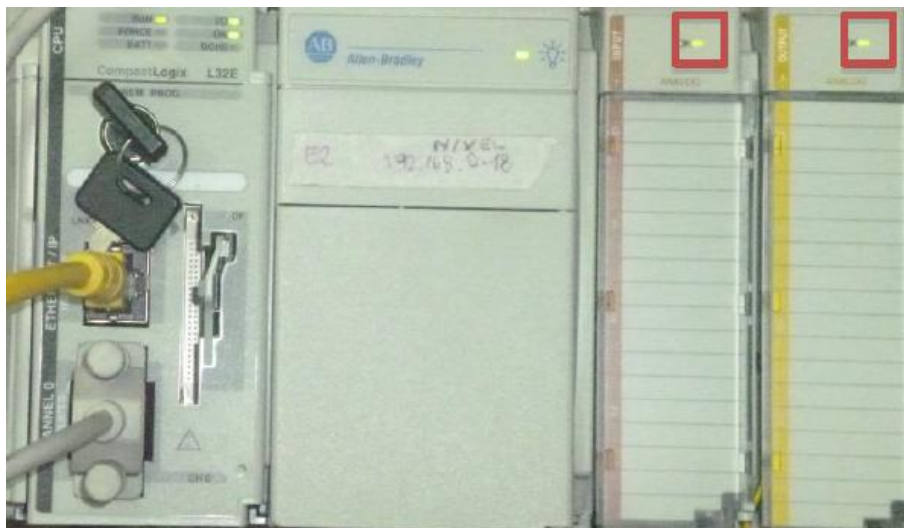
Figura 3.2: Leds indicadores de que los módulos están funcionando correctamente.
