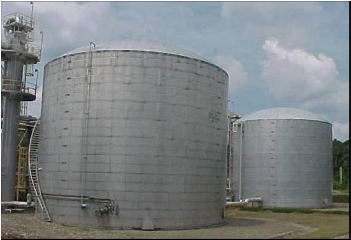
Figura. 2.9 Tanques de Almacenamiento de Crudo
