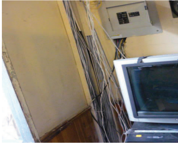
Foto 3.6. Cables expuestos al aire libre-Jefatura de sistemas
