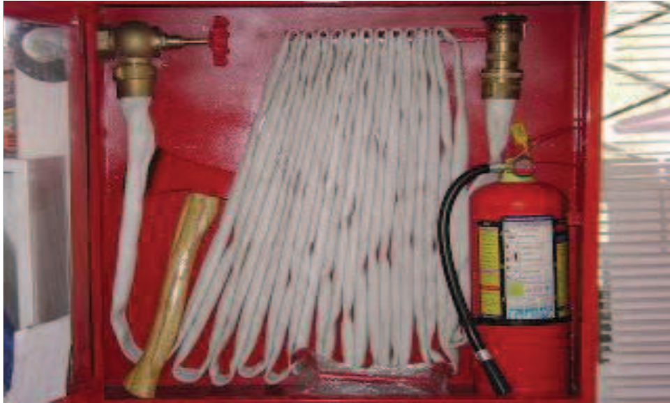
Figura 2.8 Boca de incendio equipada
