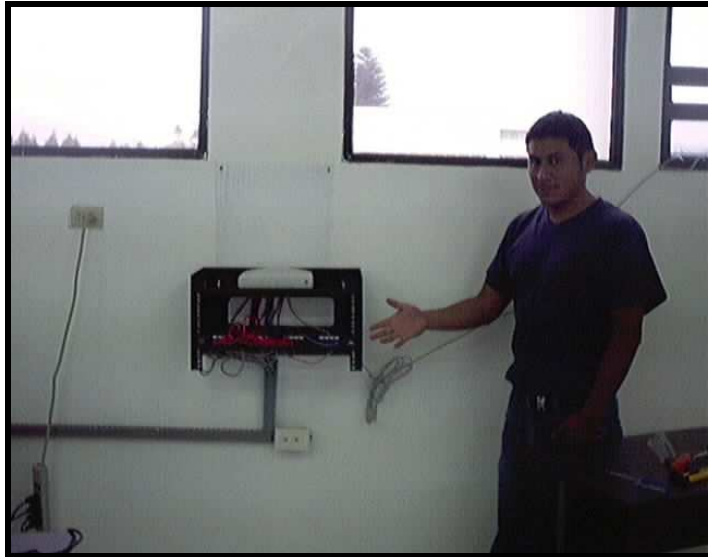
Figura A.8. Implementación total del cableado estructurado
