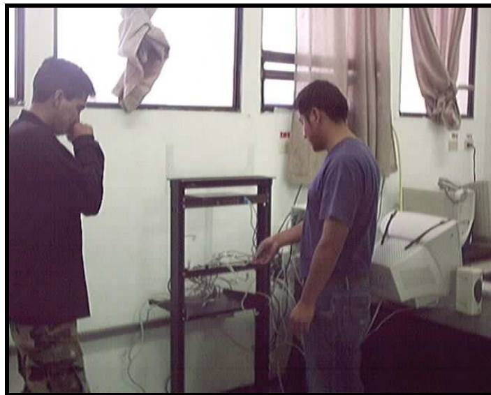
Figura A.9. Implementación de un rack de pared en el laboratorio de Internet
