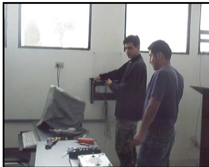
Figura A.3. Instalación del rack de pared de 6 posiciones en el laboratorio de redes
