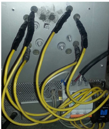
Figura 36. Instalación del Circuito de potencia
