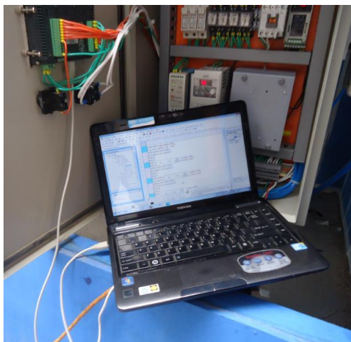
Figura 5.50.: Conexión del PLC HMI con la PC.
