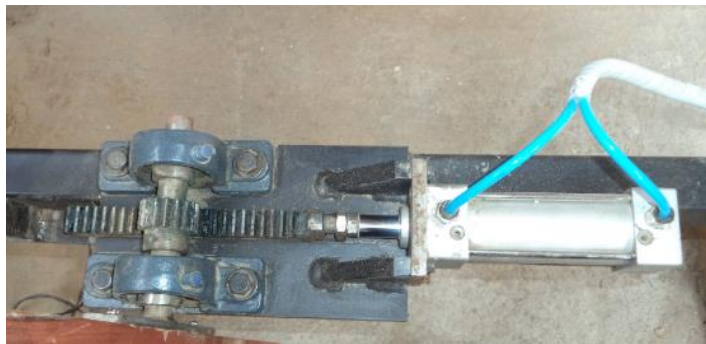
Figura 5.16.: Actuador con tubería neumática de 6 mm.
