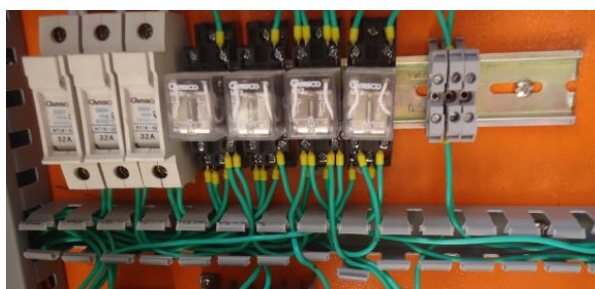
Figura 5.26.: Riel Din y Canaletas.
