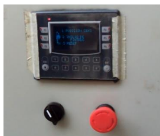
Figura 5.32.: Tablero de control.
