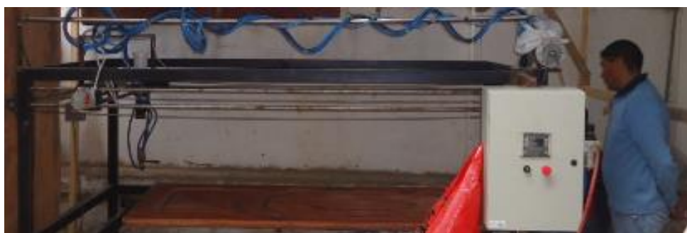
Figura 5.24.: Rieles de cableado.
