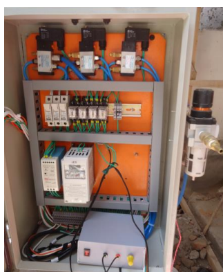
Figura 5.25.: Tablero de control.
