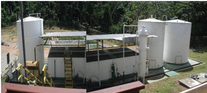
Fotografía. 4.15. Planta de Tratamiento de Agua Potable Fuente: autor 2007
