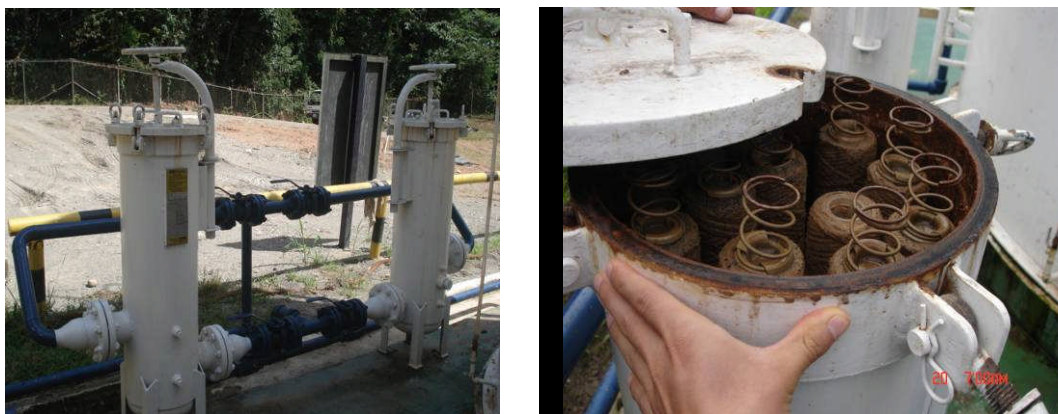
Fotografías: 4.22. Izq. y 4.23. Der. Filtros de hilo Fuente: autor 2007
