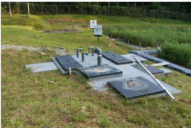
Fotografía: 7.1. del Anexo 16. Tanque Imhoff Fuente: autor 2008
