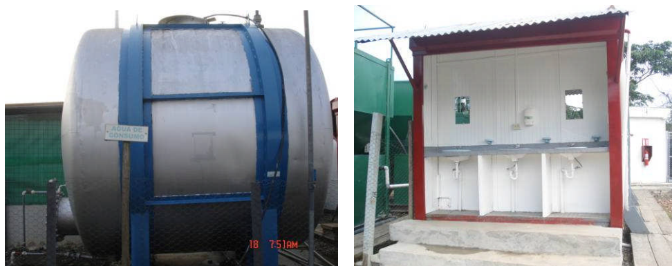
Fotografías. 4.5. Izq. y 4.6. Der. Tanque de almacenamiento; grifos de abastecimiento de agua.
