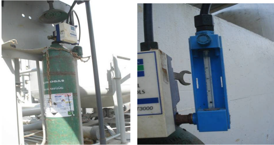
Fotografías: 4.24 Izq. Sup. Tanque de Cl gas y Clorador; 4.25 Der. Sup. Rotámetro Fuente: autor 2007
