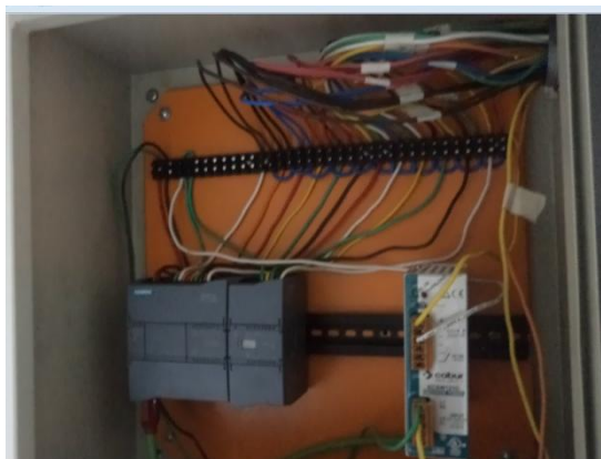
Figura 3.12: Conexiones realizadas en la caja principal.
