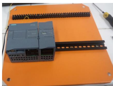
Figura 3.9: Asegurar el PLC y el módulo.
