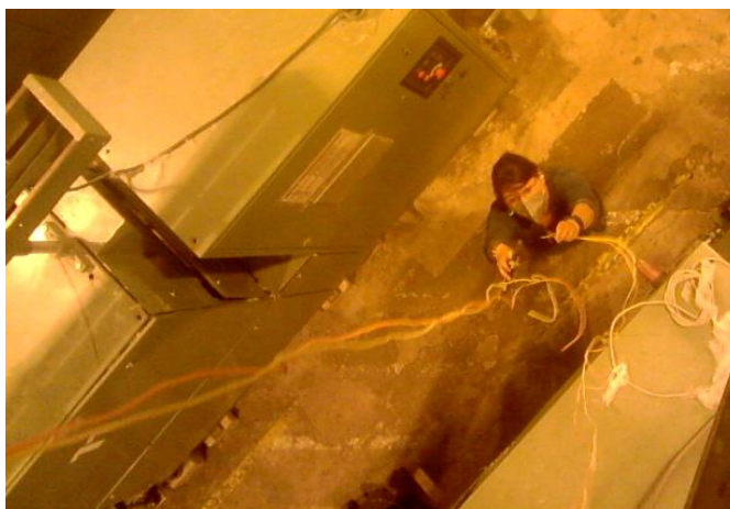
Figura 3.3: Cables para conexión de las máquinas.
