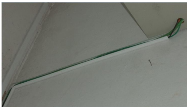
Figura 3.13: Canaleta para colocación de cable Ethernet.
