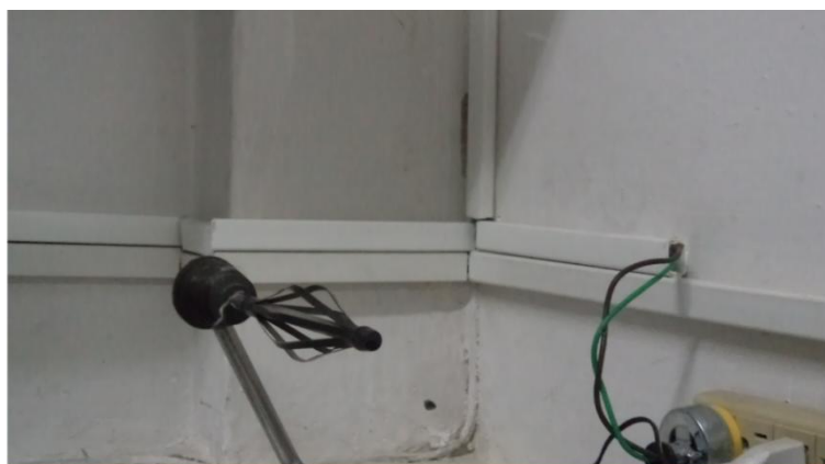
Figura 3.14: Canaleta para colocación de cable de alimentación.
