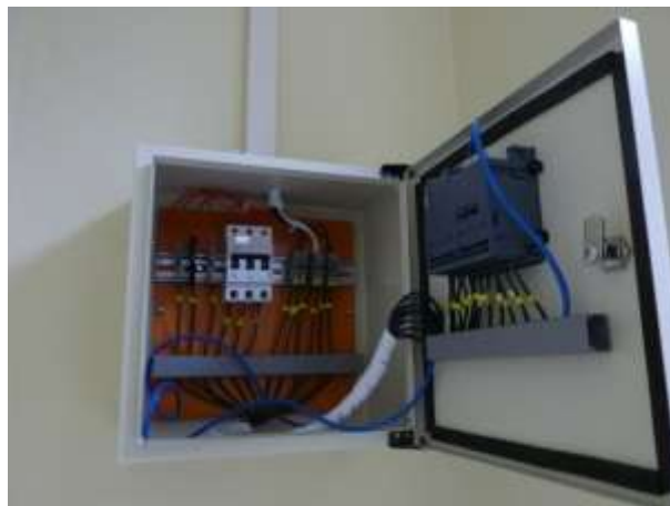
Figura 3.3: Conexión del medidor de energía Sentron PAC 3200.
