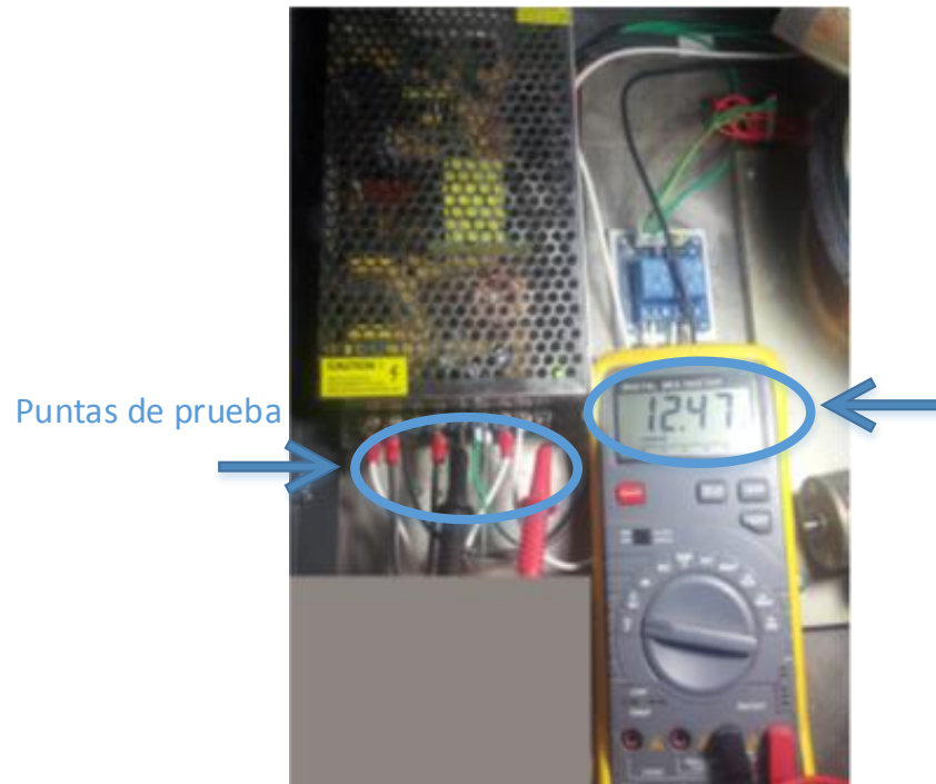
Figura 62. Voltaje 12VDC de la fuente.
