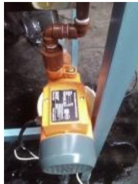
Figura 3.13: Montaje Bomba Hidráulica.
