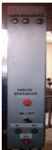
Figura 3.20: Tablero de mando y Control.
