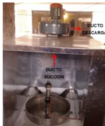
Figura 3.17: Sistema de cortina de agua y extracción de esmalte.
