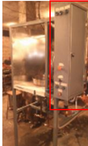
Figura 3.18: Tablero de control y de mando.
