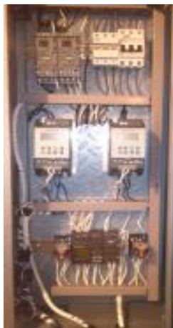
Figura 3.19: Tablero del circuito de fuerza.
