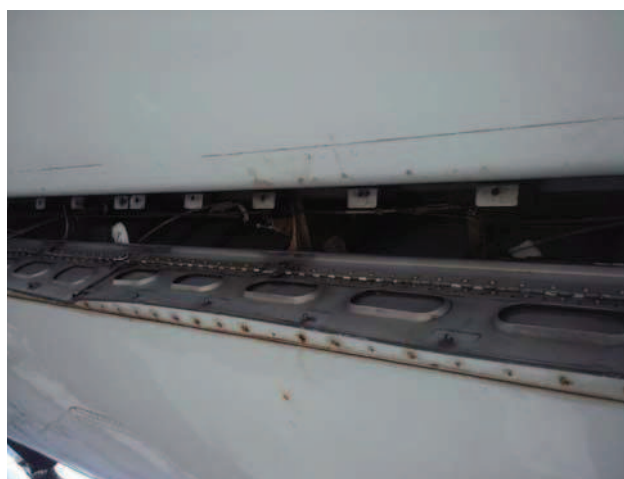
Figura 3.9: Tapas de acceso a cables tensores y poleas removidas Fuente: Fernando Caicedo
