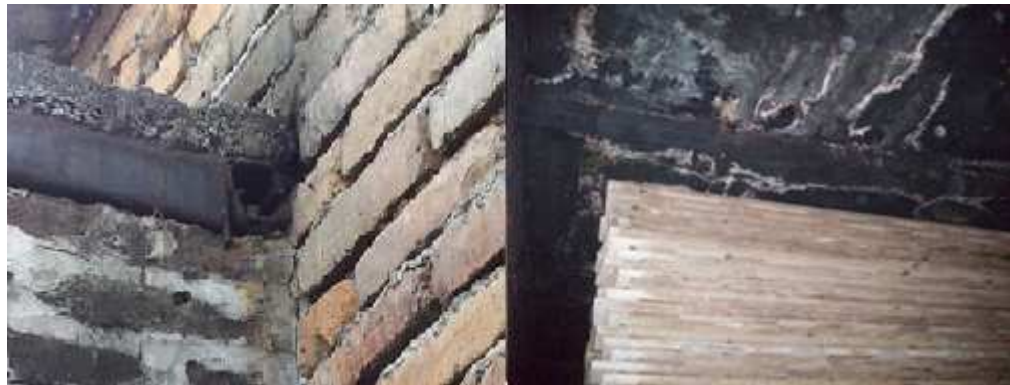
Figura 3.11: Pandeo de viga longitudinal y deformación de viga transversal
