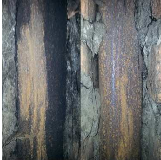
Figura 3.13: Corrosión en columnas
