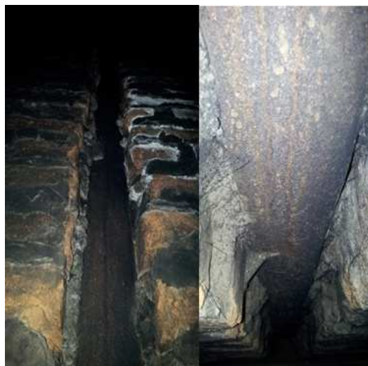
Figura 3.12: Corrosión en columnas
