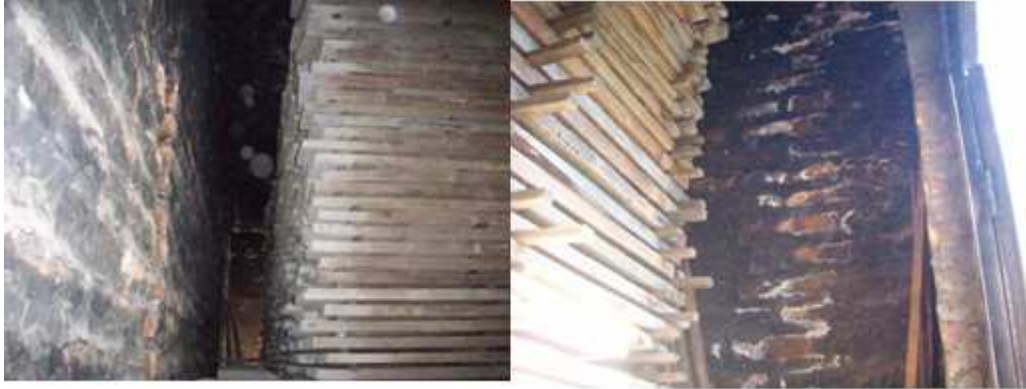
Figura 3.10: Deterioro de paredes por gases de combustión
