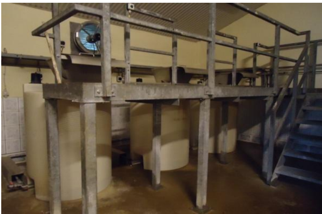
Figura 2.8. Depósitos de Carbonato de Sodio y Sulfato.
