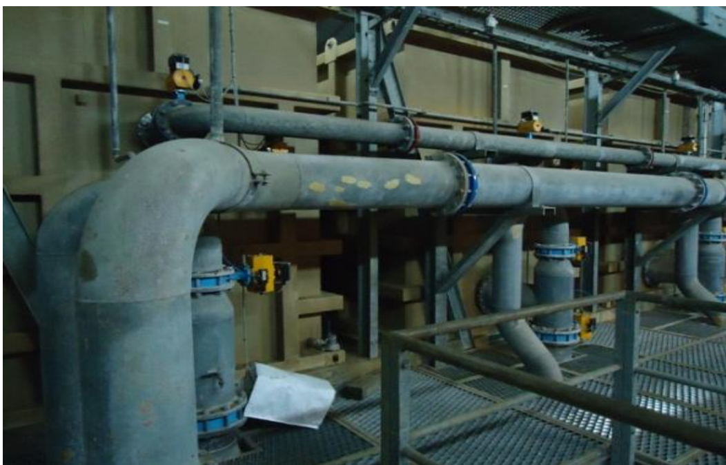
Figura 2.4. Actuadores neumáticos distribuidos en todos los tanques.
