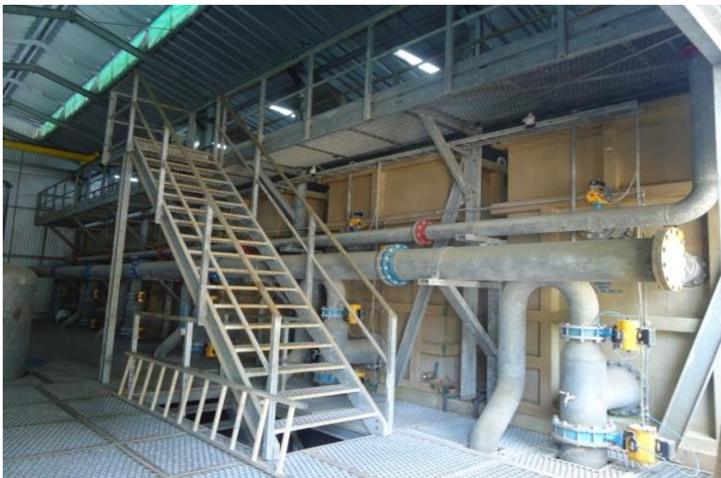
Figura 2.1. Depósitos Filtrantes, donde llega el agua para el proceso final.
