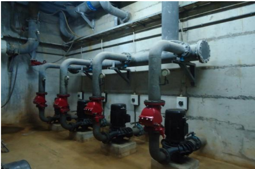
Figura 2.7. Bombas de evacuación de agua filtrada.
