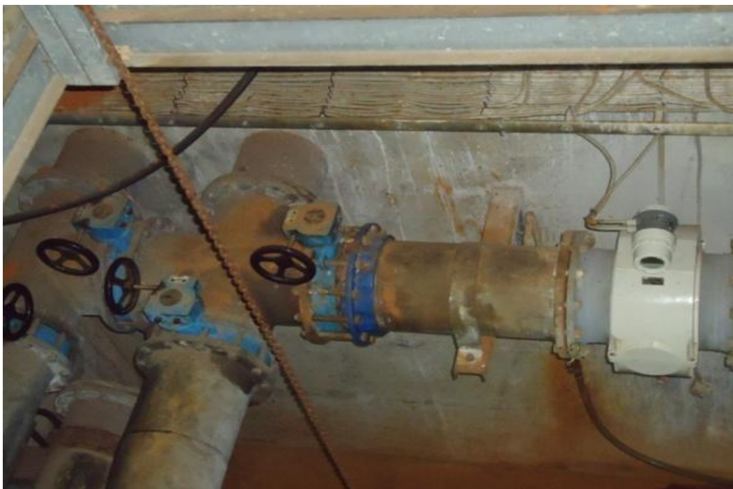
Figura 2.5. Fluxómetro situado en la entrada del agua a tratar.
