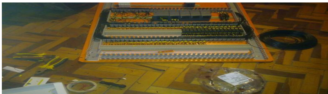
Figura 3.13. Tablero de control en pleno proceso de constitución
