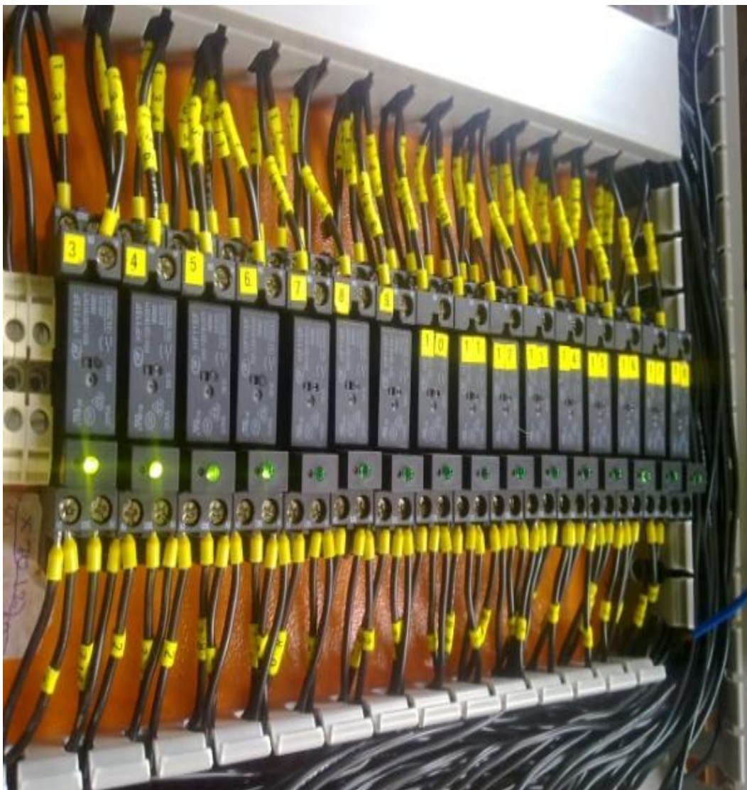
Figura 3.14. Borneras y etiquetas
