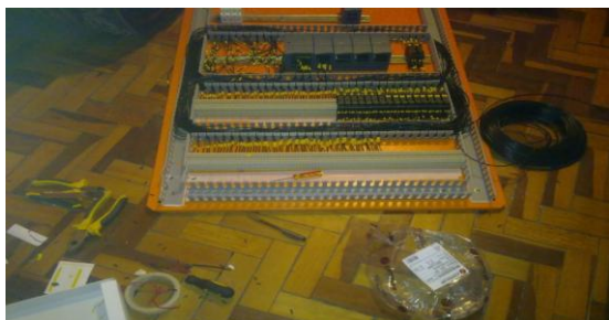
Fig. 4. Tablero de control en pleno proceso de constitución
