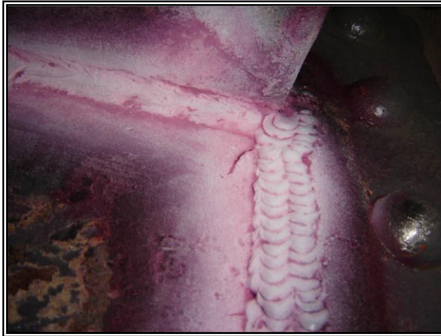
Continuación de una grieta en el material base que se trató de tapar con cordones de soldadura
