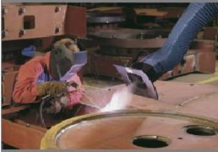
Figura 6.1: Extracción localizada en procesos de soldadura (individual)
