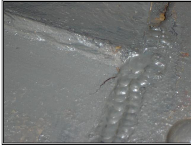
Grietas en el material base, inspección visual
