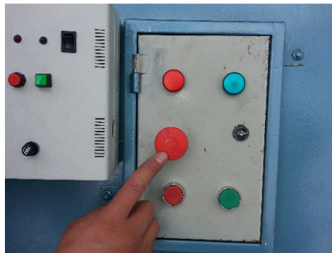
Figura 4.7 Control manual de parada de emergencia.
