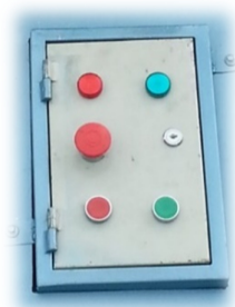
Figura 3.68 Arrancador botonera motor trifásico 220 V WEG.
