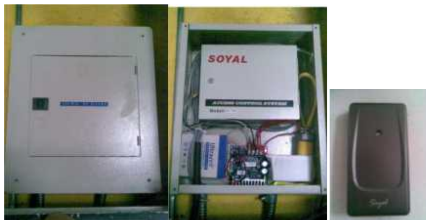
Figura 1.3. Fotografías Subsistema de control de acceso: Controladoras y lectora Edificio Beltrán - Quito.
