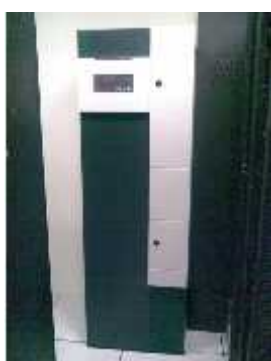
Figura 1.1. Fotografía de aire acondicionado en edificio Beltrán - Quito.
