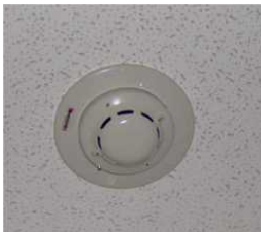
Figura 1.4. Fotografías Subsistema de detección y control de incendio: sensor de humo Edificio Beltrán - Quito.
