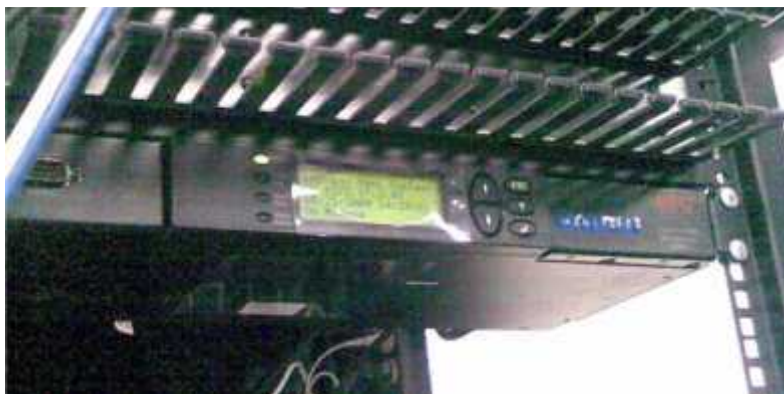
Figura 1.5. Fotografías Subsistema de monitoreo: unidad central Edificio Beltrán - Quito.
