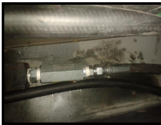
Figura 4. 25. Conexión a la válvula check.
