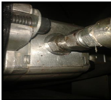
Figura 4. 13. Toma de entrada de la bomba hidráulica.
