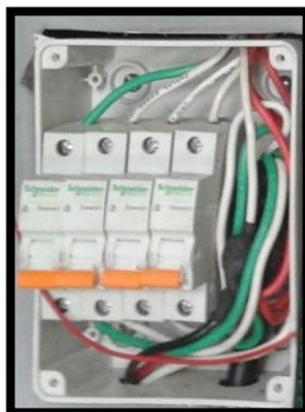
Figura 2. 25. Caja de fusibles Fuente: Autores.
