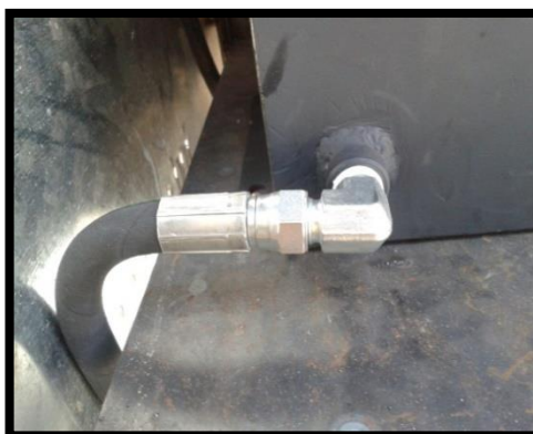
Figura 4. 12. Toma de salida del depósito B.
