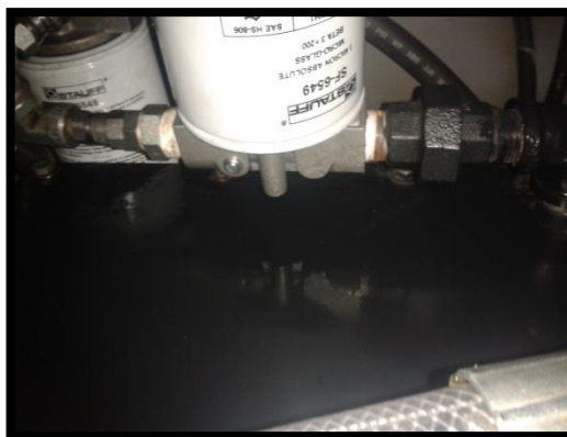
Figura 4. 17. Recirculación de Fluido al depósito B.
