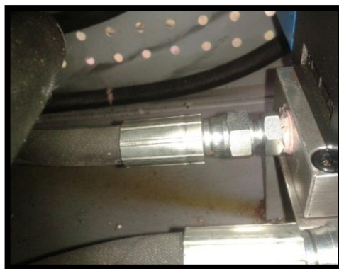
Figura 4. 19. Toma de salida (T) de la sub-placa B. Fuente: Autores
