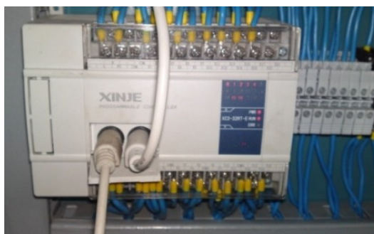
Figura 4.60 Conexión del PLC.
