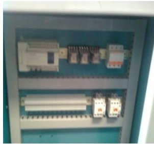
Figura 4.41 Disposición de elementos en el tablero eléctrico.
