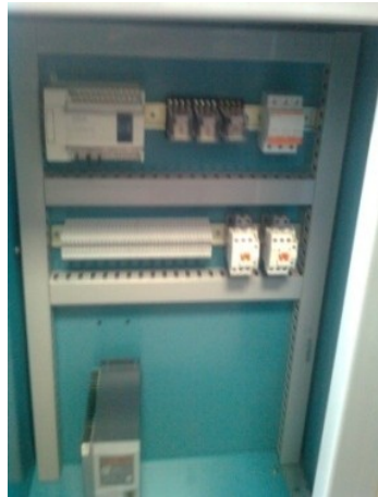
Figura 3.2 Tablero eléctrico de la máquina.
