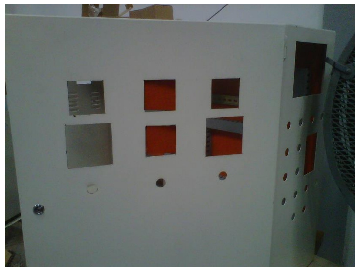
Figura 3.7. Tablero de control vista lateral.
