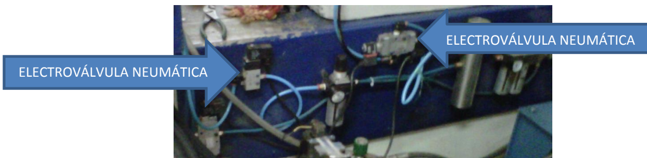
Figura 2.9. Electroválvulas neumáticas instaladas.
