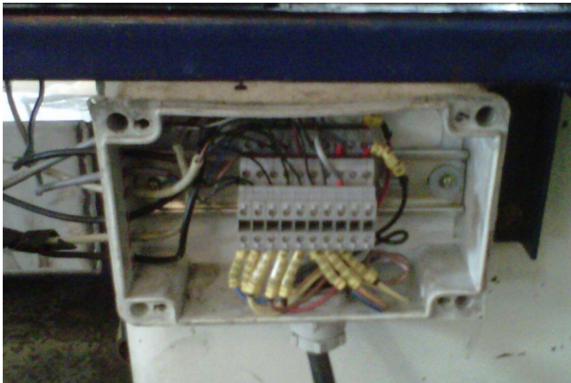
Figura 3.27. Caja de borneras para sensores inductivos.
