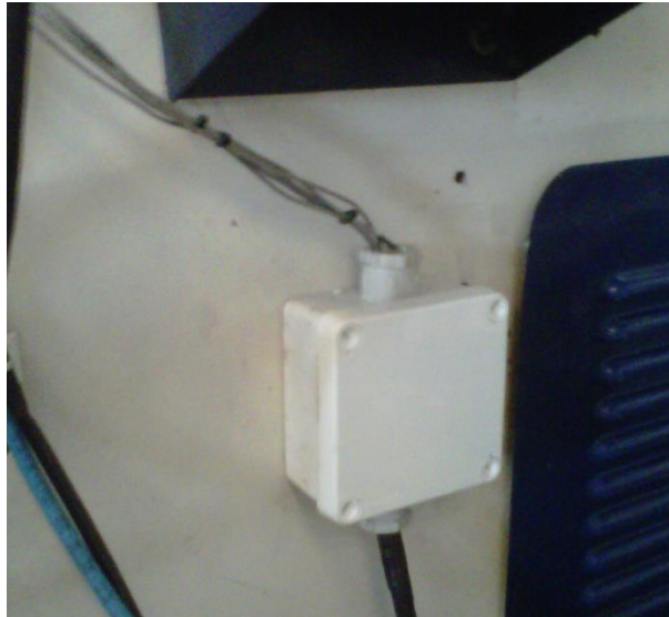
Figura 3.26. Caja de borneras para las termocuplas.
