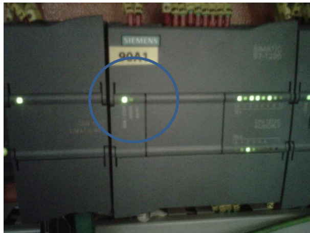
Figura 4.3. Arranque del PLC.
