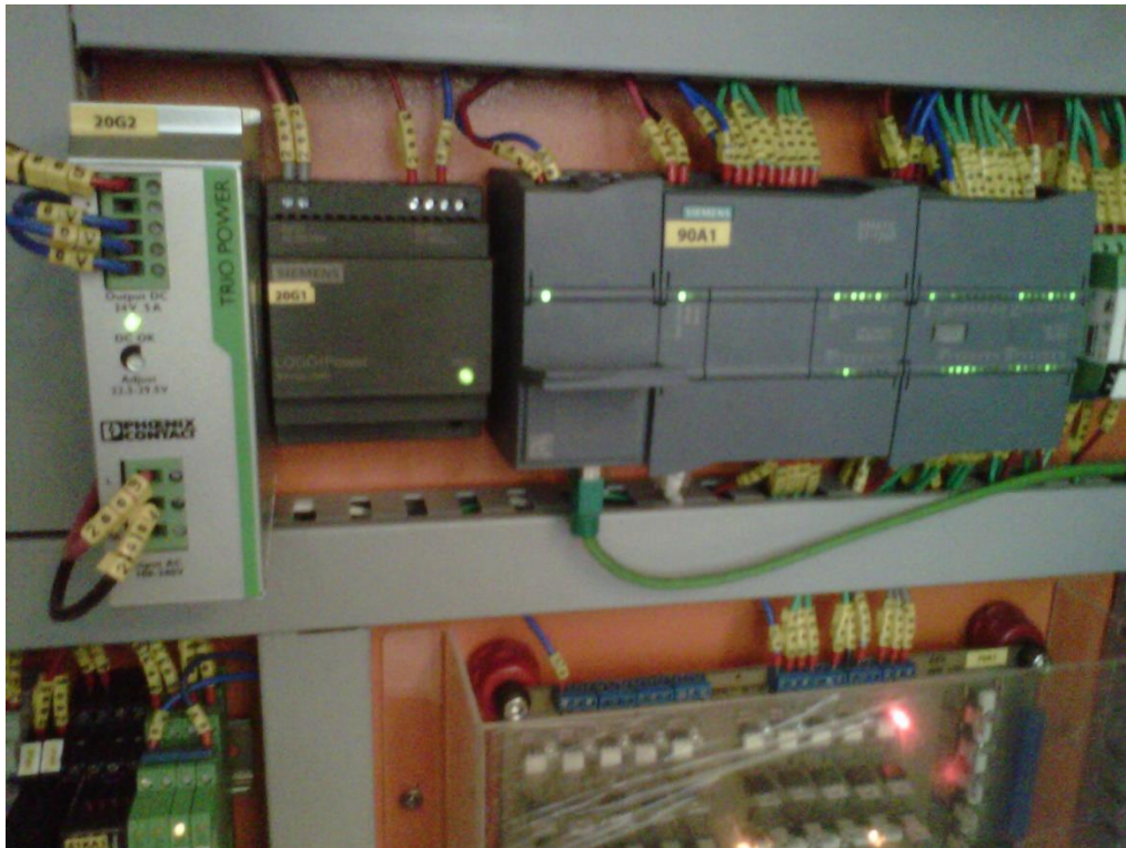
Figura 3.25. Cableado del sistema eléctrico de fuerza y control.
