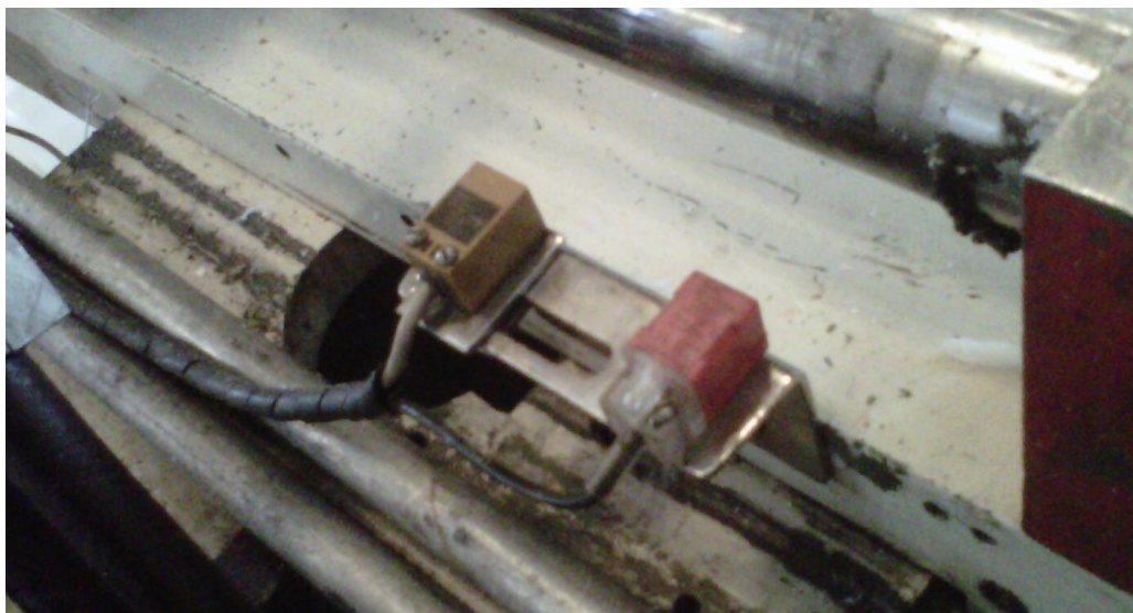
Figura 3.31. Montaje de los sensores inductivos para posicionar el carro.
