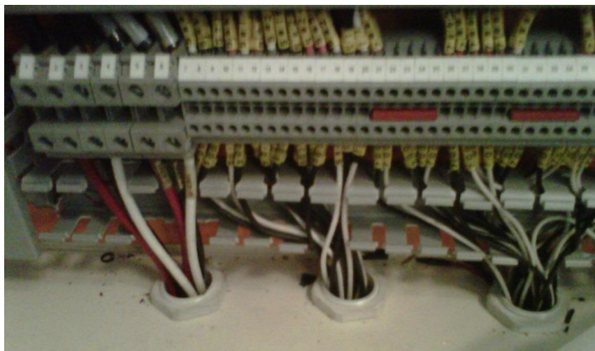
Figura 3.29. Conexión de motores y electroválvulas a los bornes del tablero de control.
