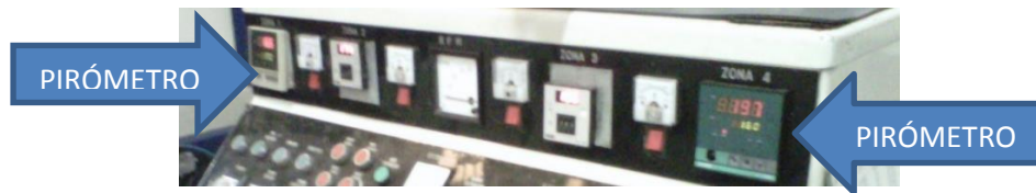
Figura 2.5. Controlador de Temperatura (Pirómetro).
