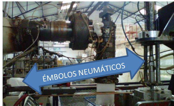
Figura 2.8. Émbolos neumáticos instalados.
