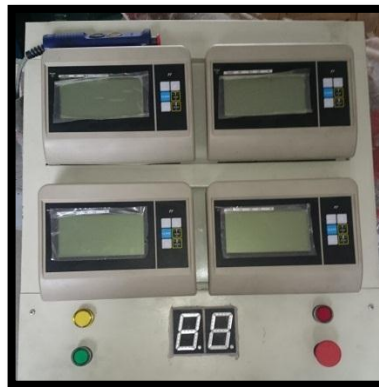
Figura 4. 32: Instalación diferentes controles e indicadores en la caja de mando
