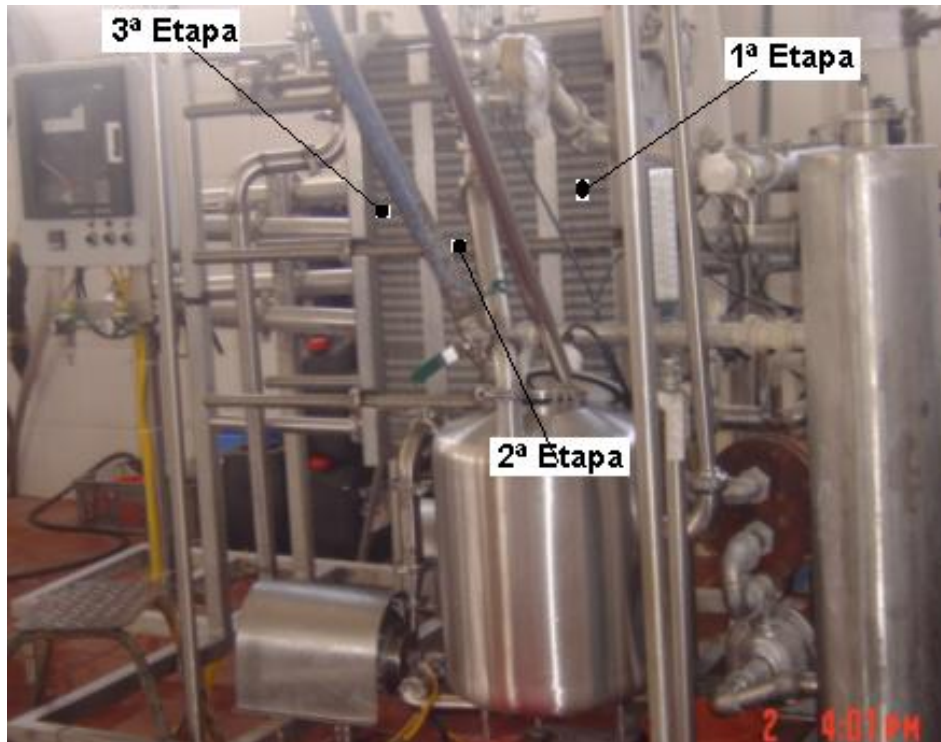
FIG3.5. PASTERIZADOR UTILIZADO EN ILCSA. ES UN INTERCAMBIADOR DE PLACAS DE TRES NIVELES, 2 DE CALENTAMIENTO Y UNO DE ENFRIAMIENTO.
