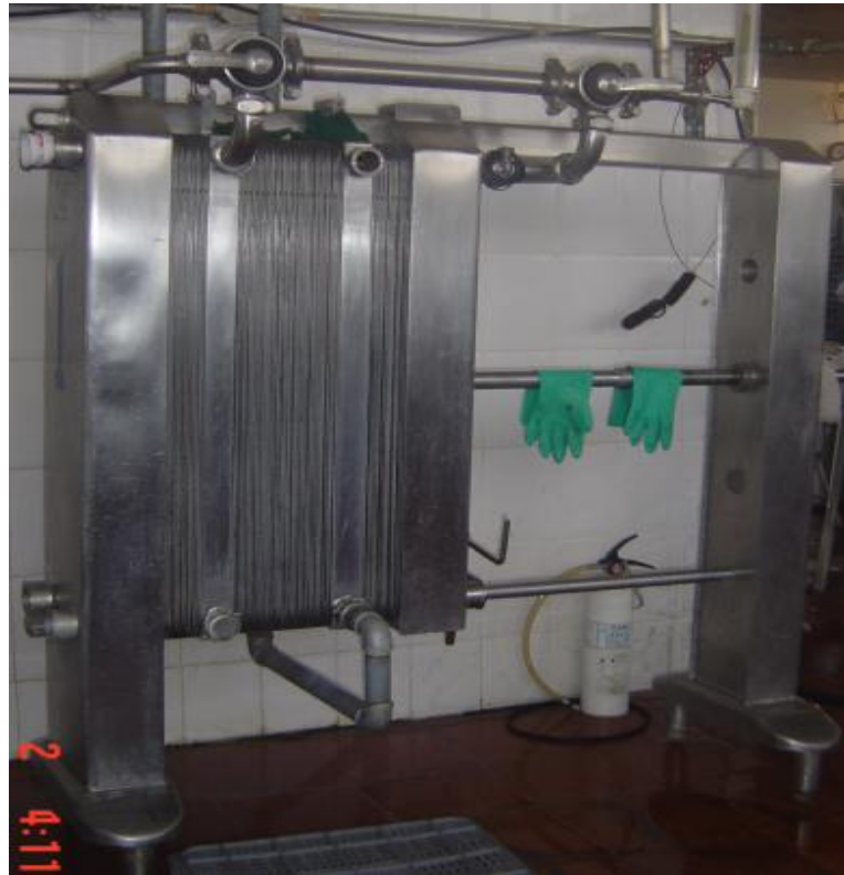
FIG3.4. INTERCAMBIADOR DE PLACAS PARA EL PREENFRIADO DE LA LECHE CRUDA.
