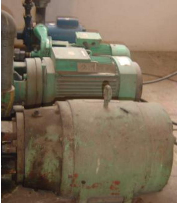
FIG3.20. BOMBAS UTILIZADAS PARA LA DISTRIBUCIÓN DE AGUA FRÍA
