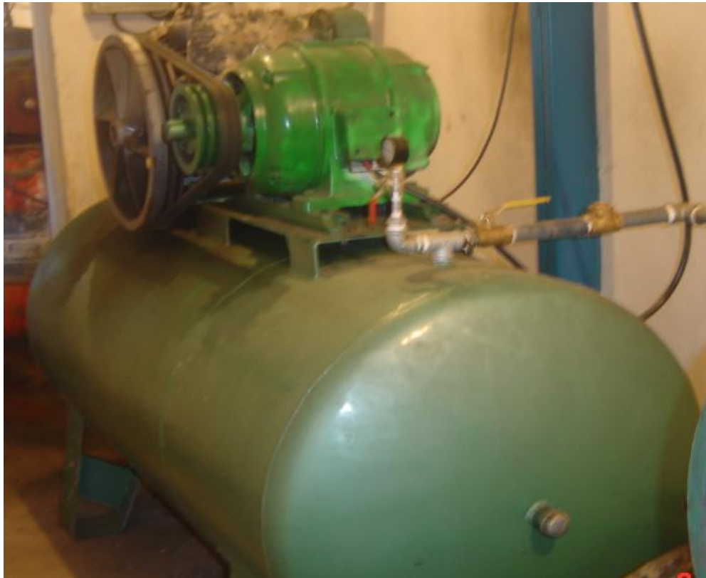
FIG3.18. COMPRESOR DE 13.5 HP, FUENTE PRINCIPAL DE AIRE COMPRIMIDO
