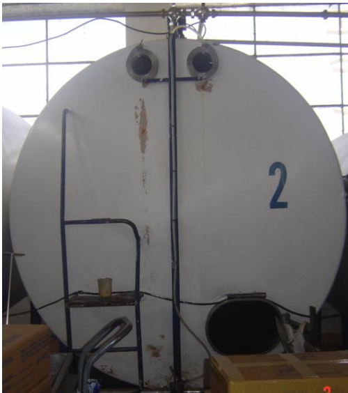
FIG3.7. TANQUE DE 10000 LITROS
