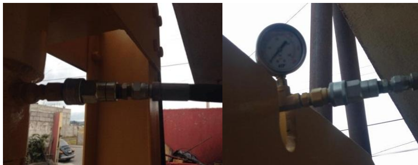
Figura 4. 90 Acoples rápidos y manómetro del sistema electrohidráulico Elaborado por: Carrera C. & Cepeda W.
