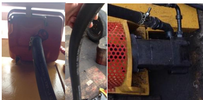
Figura 4. 87 Manguera de 290PSI tanque - bomba hidráulico Elaborado por: Carrera C. & Cepeda W.
