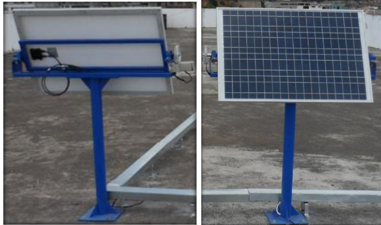
Figura 3.3: Estructura metálica del panel solar
