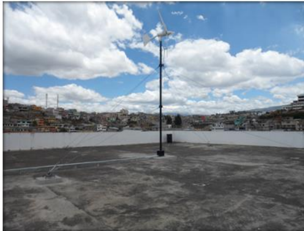
Figura 3.13: Torre tubular del aerogenerador
