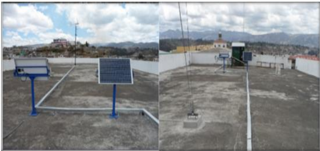
Figura 3.15: Cableado del aerogenerador y paneles
