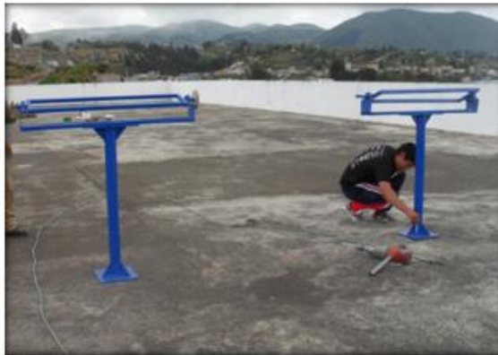
Figura 3.1: Estructura metálica del panel solar Elaborado por: Herrera – Mullo
