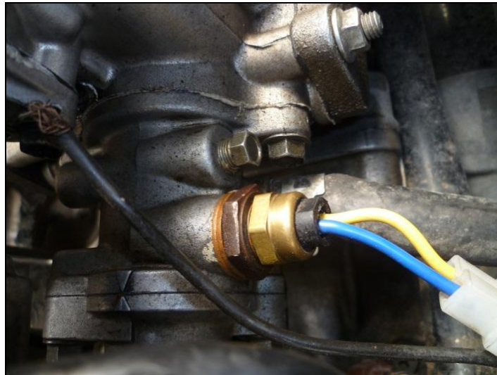
Figura. 5.11: Montaje sensor WTS
