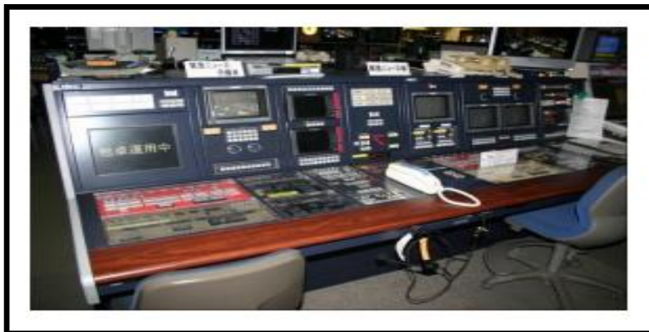
Figura 3. Consola de Noticias de Emergencias.
