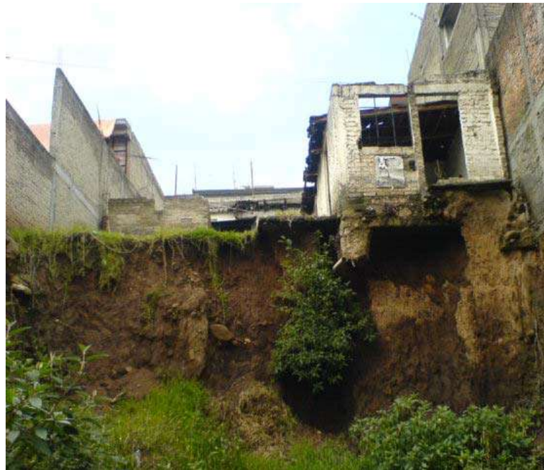
Figura 3.6 Zona inestable en erosión (Autores)
