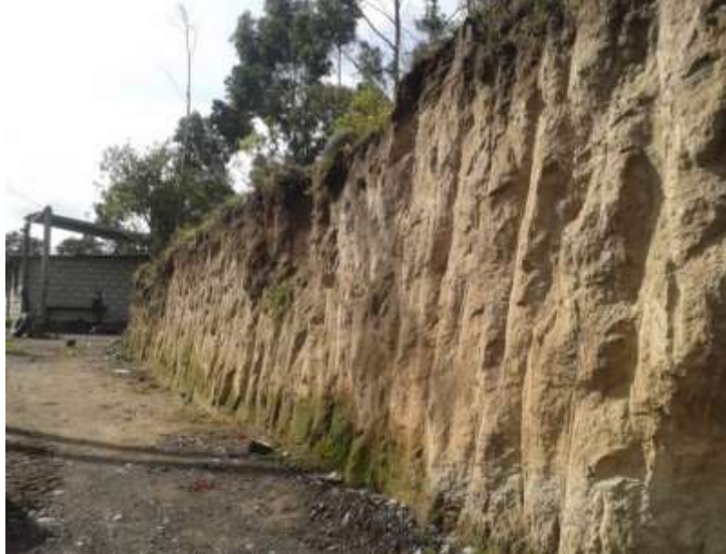
Figura 5.2 Talud previo la limpieza (Autores)
