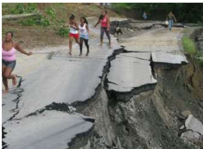
Figura 3. 12 Deslizamiento en Pedernales ( www.elcomercio.com )
