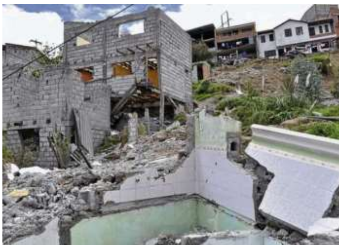
Figura 3.11 Deslizamiento en Sinincay ( www.elcomercio.com )
