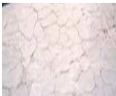
Figura 1.5 : Fisuración en bloque
