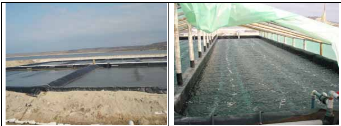
Fig. N° 4. Estanques revestidos con geomembrana
