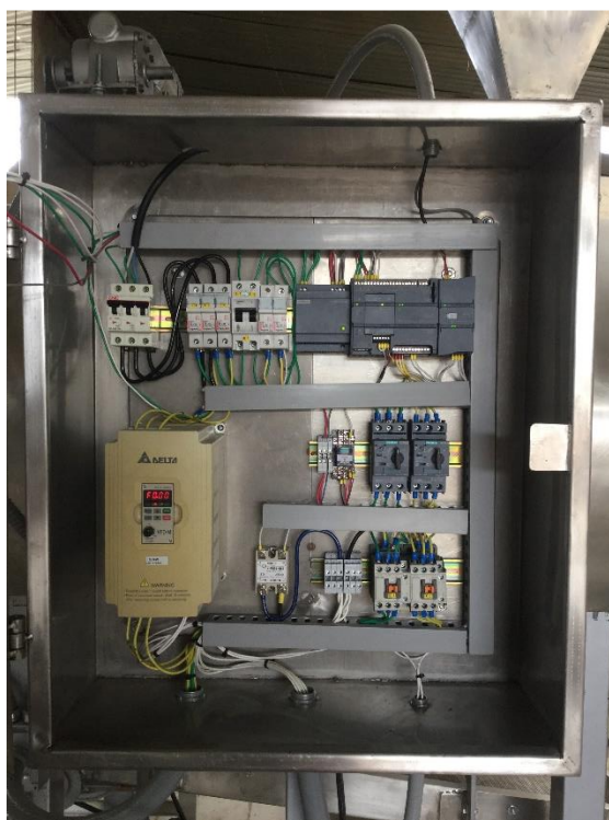
Figura 3.22. Conexiones internas tablero de control
