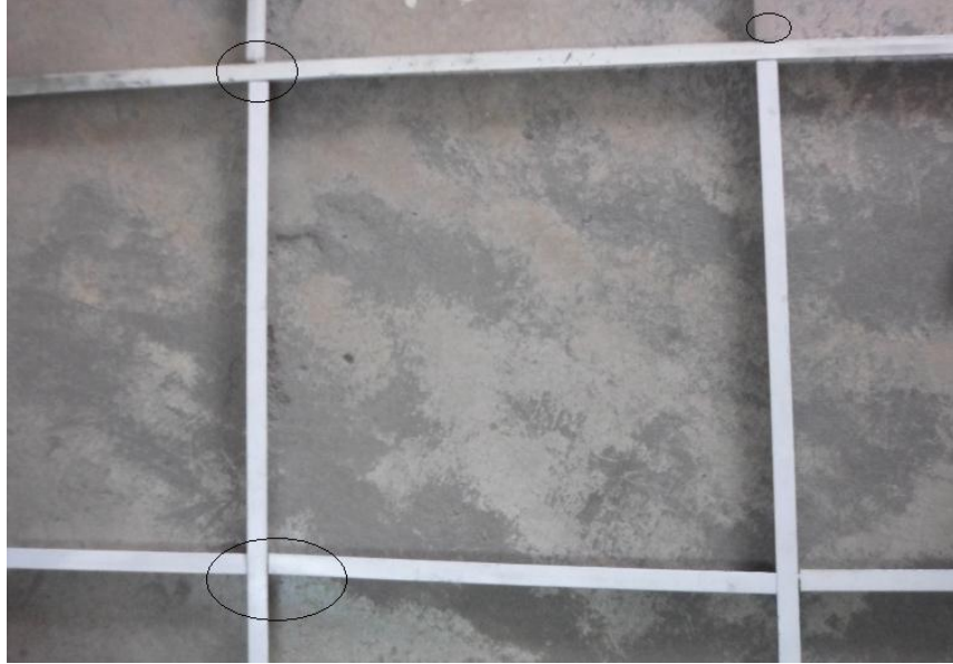
Figura 3. Fallas por inexactitud en perfilería nacional
