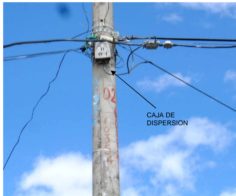
Figura 1.34 Foto de poste con caja y cables de dispersión
