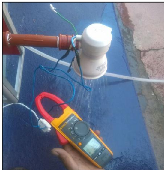
Figura 76 Medición de corriente de entrada ducha eléctrica.
