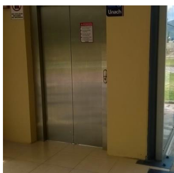
Figura 329 Ascensor del edificio de la Facultad de Ingeniería
