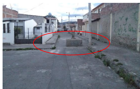
Figura 384 Aceras angostas con mobiliario urbano mal ubicado
