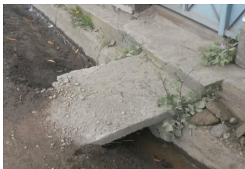
Figura 434 Acera con rampa inadecuada
