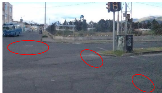
Figura 392 Falta de pasos peatonales
