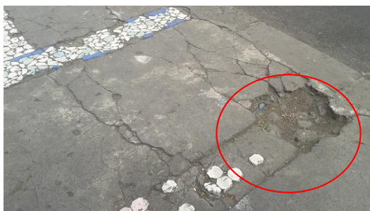
Figura 400 Vado vehicular con el piso fisurado y roto
