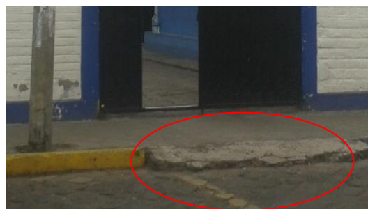
Figura 401 Vado vehicular en mal estado
