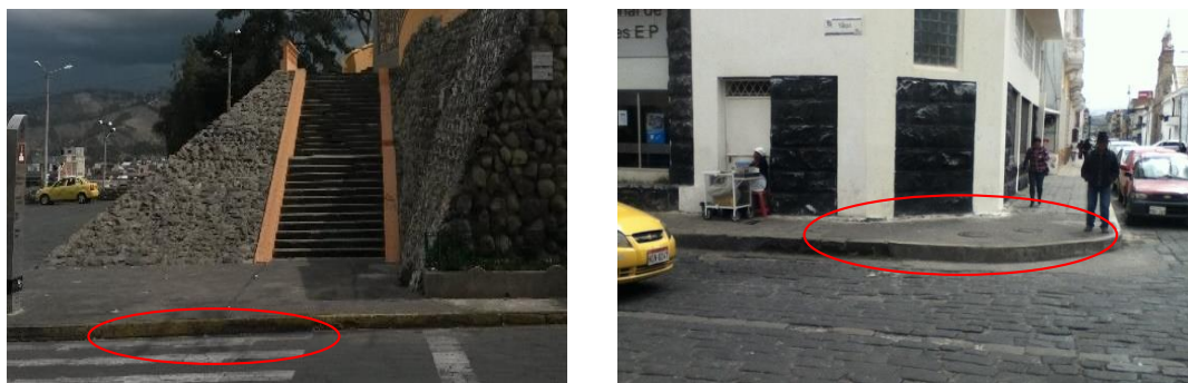
Figura 397 Falta de vados peatonales
