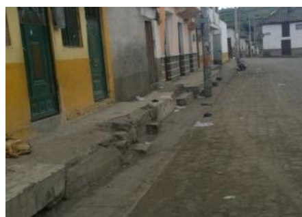
Figura 431 Aceras estrechas, elevadas y destruidas
