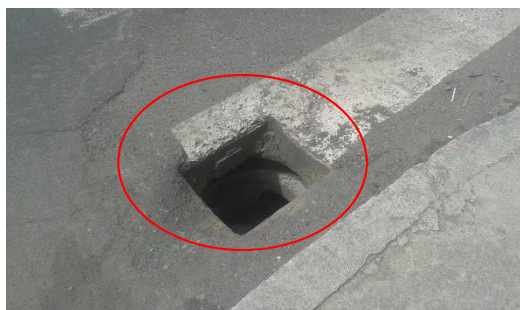
Figura 393 Sifón sin tapa en el paso peatonal
