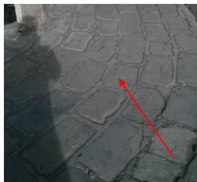
Figura 382 Piso no adecuado de la acera
