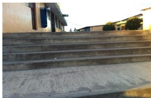
Figura 178 Gradadas sin rampa la entrada de la unidas educativa Anda Aguirre
