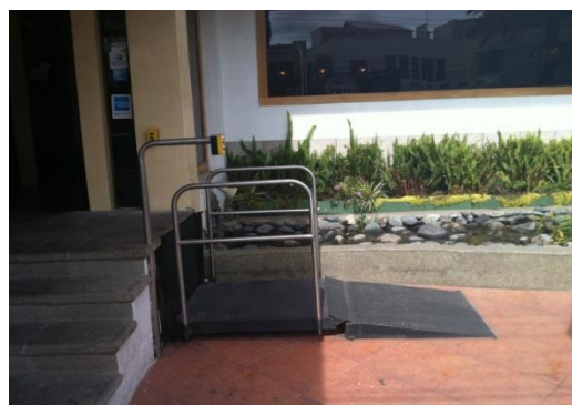
Figura 360 Plataforma elevadora del Hotel Zeus
