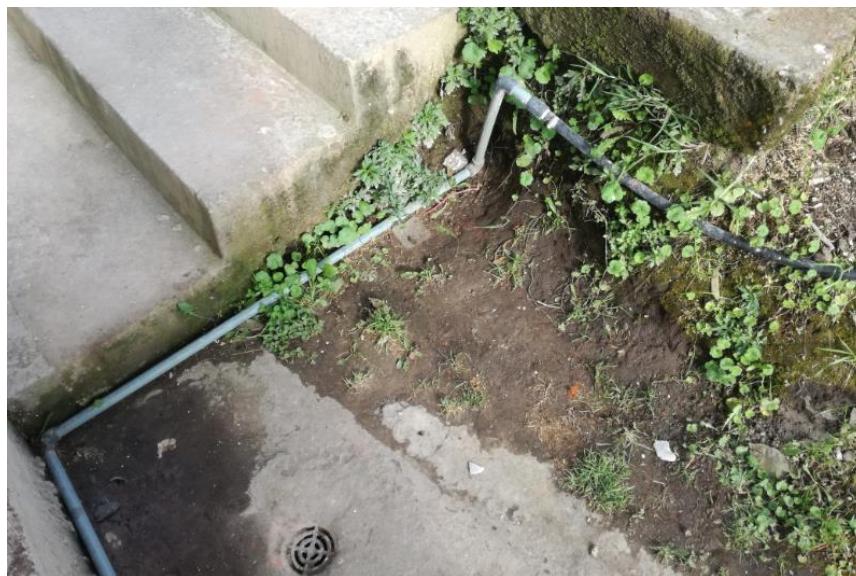
Figura 45 Conexión tubos PVC hacia manguera de polietileno
