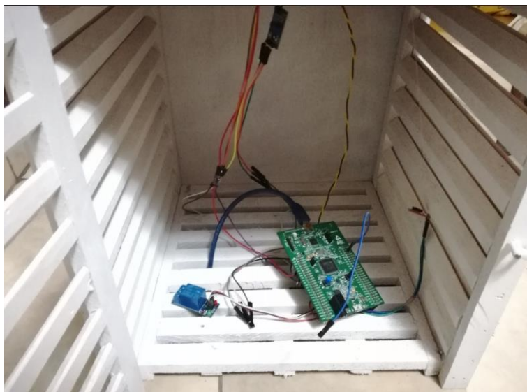
Figura 56 Controlador y sensores
