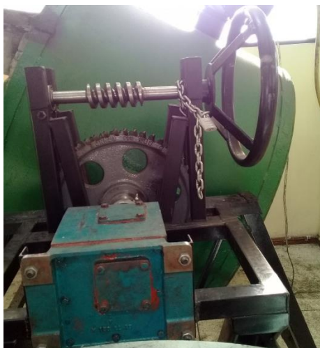
Figura 67. Verificación del sistema automático
