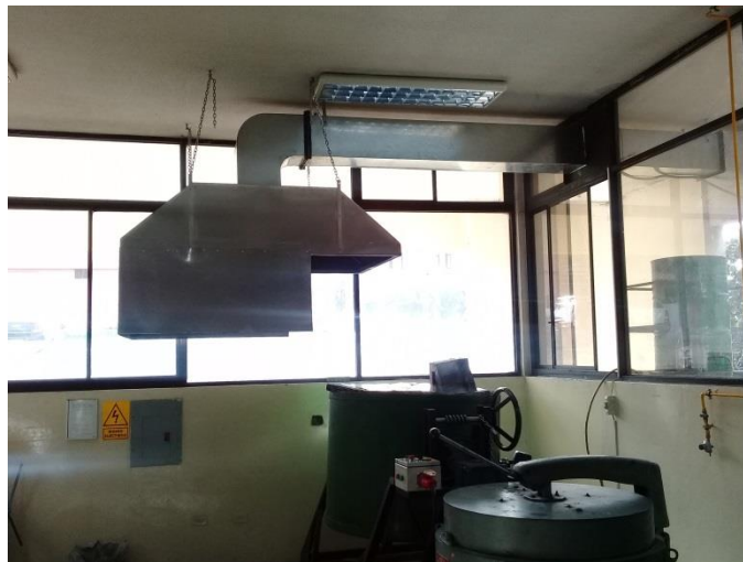
Figura 64. Sistema de extracción de gases
