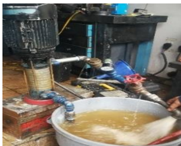
Figura 49. Prueba de funcionamiento
