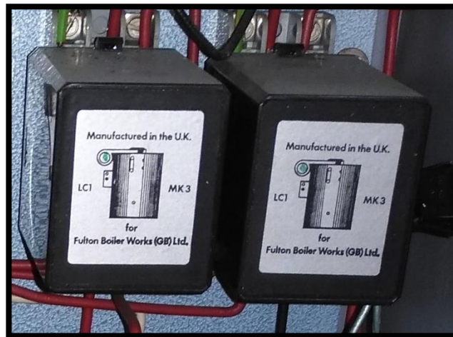
Figura 93. Controles de nivel por conductividad
