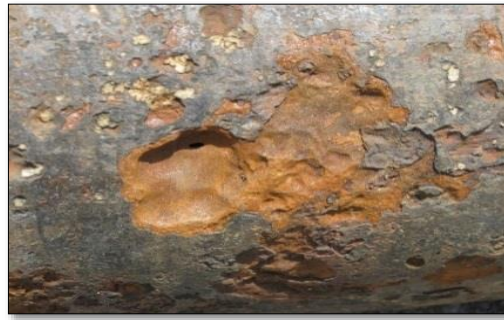
Figura 9: Corrosión en Calderos
