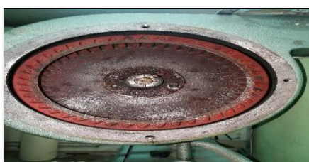
Figura 59. Ventilador desacoplado y desbalanceado
