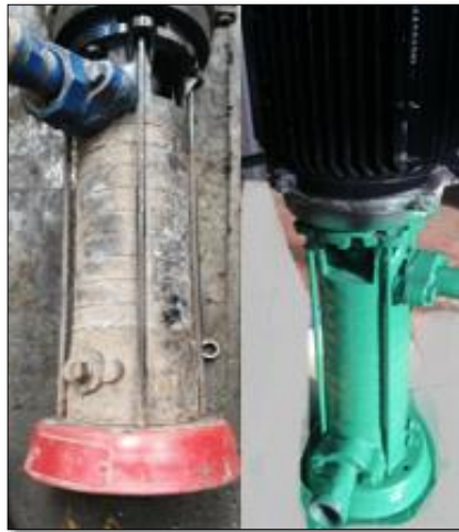
Figura 50. Antes y después Bomba centrífuga multietapa GRUNFOS CR 10
