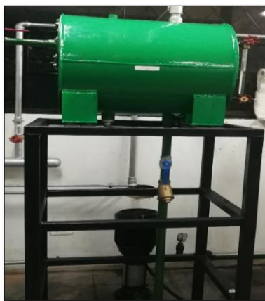
Figura 53. Tanque de condensado
