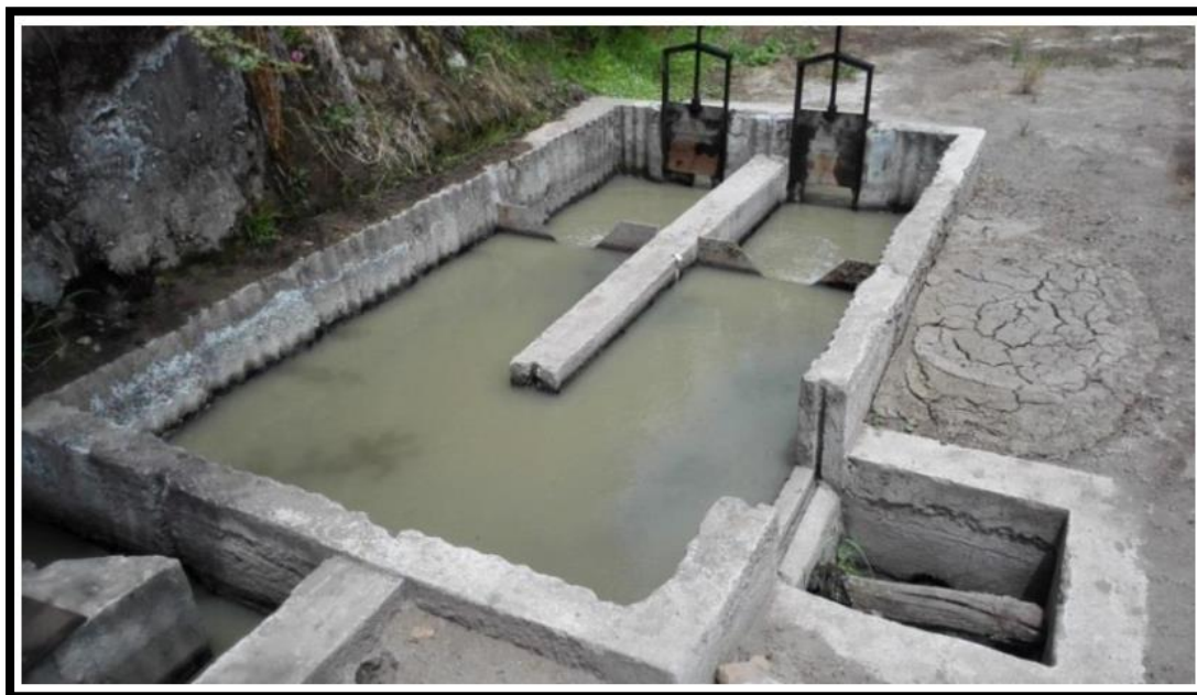
Figura 11 Cajón regulador de caudal. Fuente: (Mantilla, 2017)
