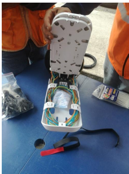
Figura 74 Reserva de fibra óptica en bandeja de empalme
