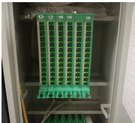
Figura 79 Bandejas de empalme en ODF
