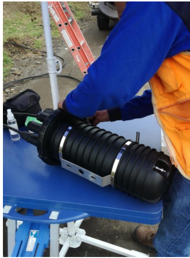
Figura 76 Cierre de manga de empalme
