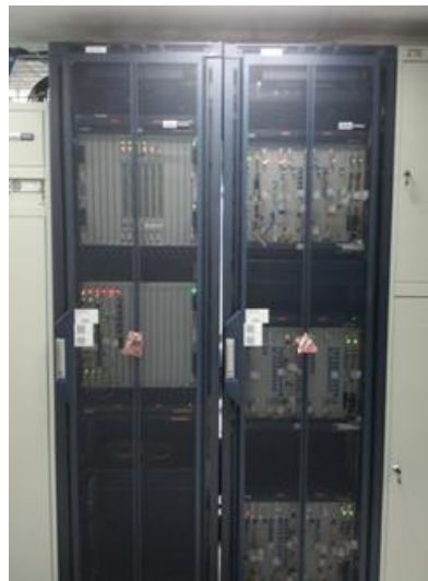
Figura 52 Rack metálico de comunicaciones Fuente: (Telepartes, 2018)
