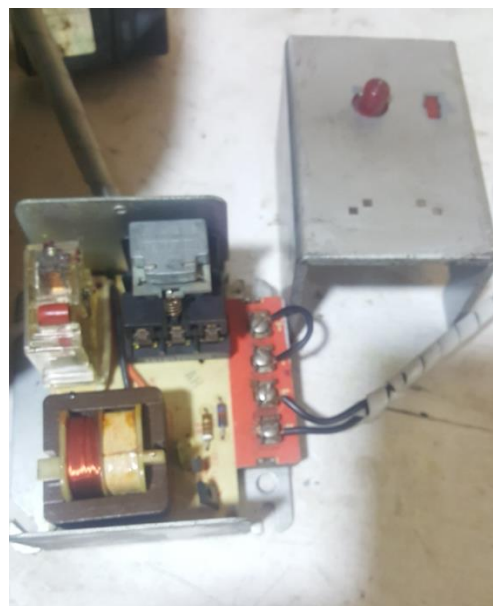
Figura 51 Controlador del Quemador Actual.
