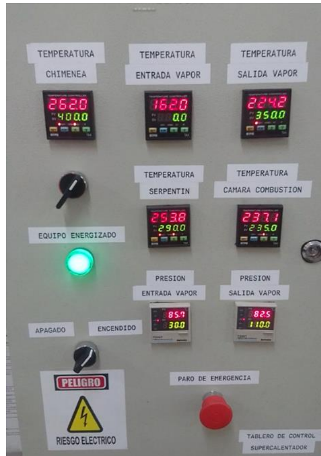
Figura 87 Datos registrados durante funcionamiento.
