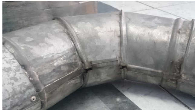
Figura 29 Ducto para gases de combustión
