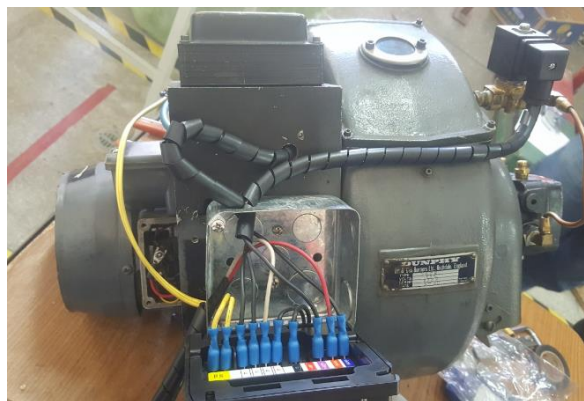
Figura 80 Montaje del Control Honeywell R784
