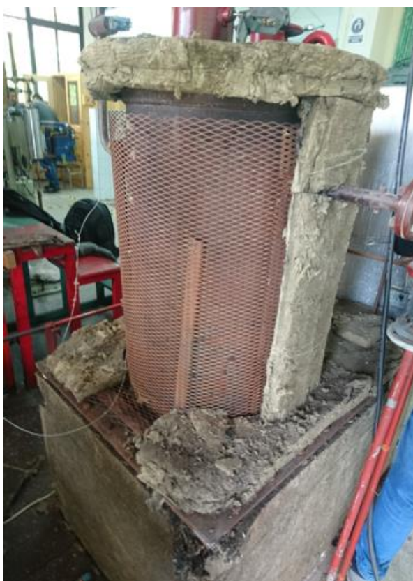
Figura 18 Chapa metálica del supercalentador
