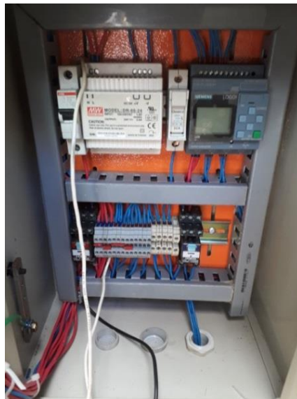
Figura 76. Implementación de PLC
