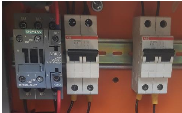
Figura 80. Sistemas de Protección
