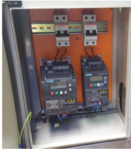
Figura 77. Sistema de Potencia
