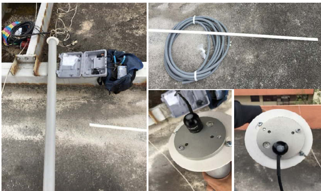
Figura 21. Instalación de Piranómetro.
