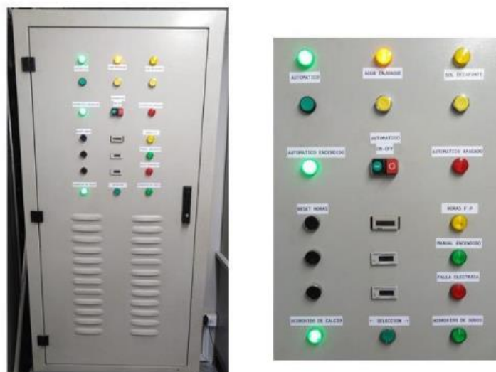
Figura 118. Pulsadores de Emergencia Digital y Físicos.
