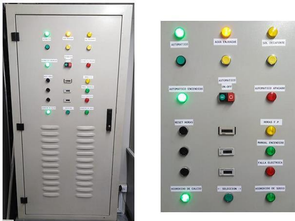
Figura 99. Sistema de Control por pulsadores de la planta Ptari.
