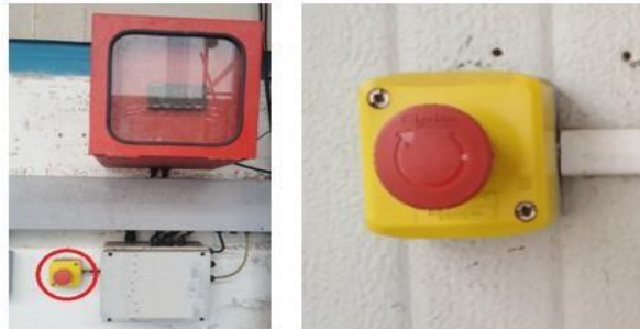
Figura 117. Pulsadores de Emergencia físicos.
