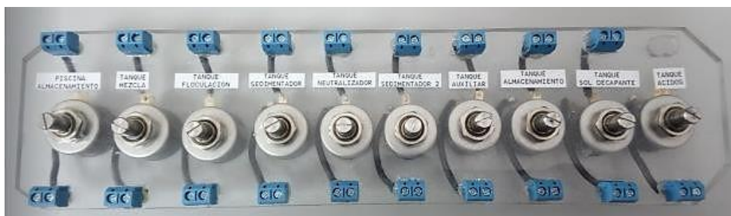
Figura 96. Banco de Potenciómetros
