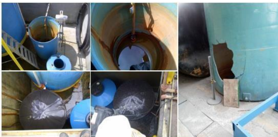
Figura 31. Tanque de Tratamiento
