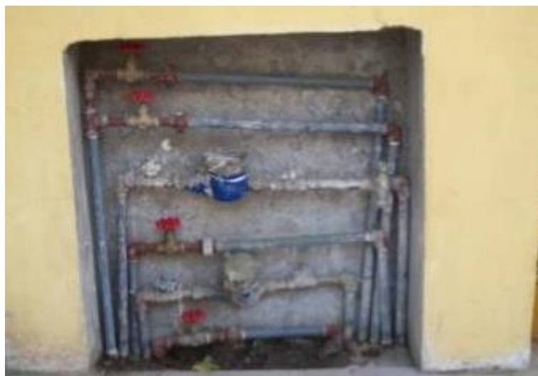
Figura 23. Acometida edificio calle Sucre
