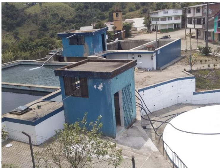
Figura 12. Planta de Tratamiento de Agua Potable
