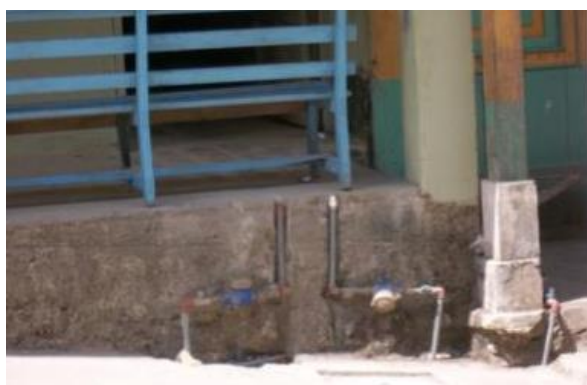
Figura 21. Acometida sin protección
