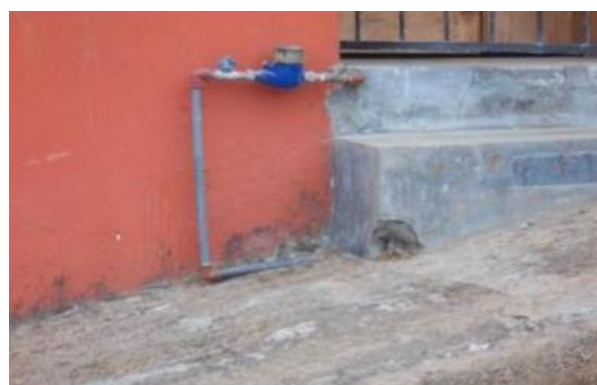
Figura 22. Acometida sin protección
