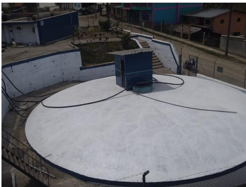
Figura 14. Tanque de reserva de 400 m 3
