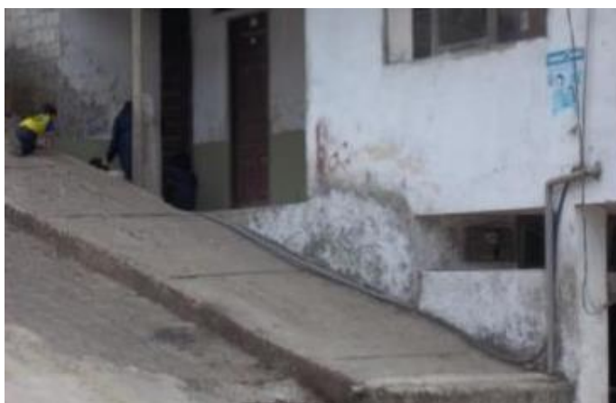
Figura 20. Acometida domiciliaria al aire libre
